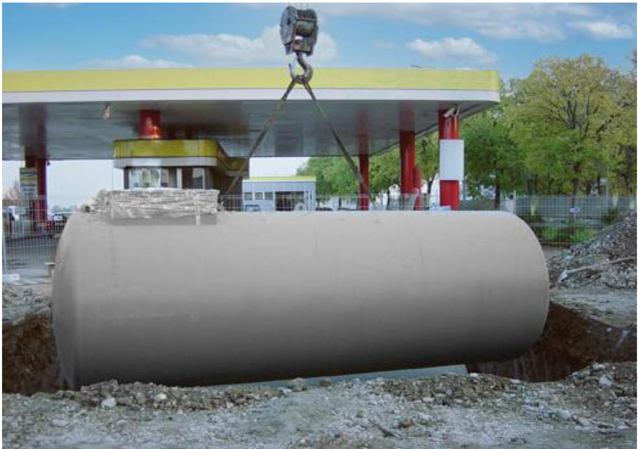
Tanque de combustible
