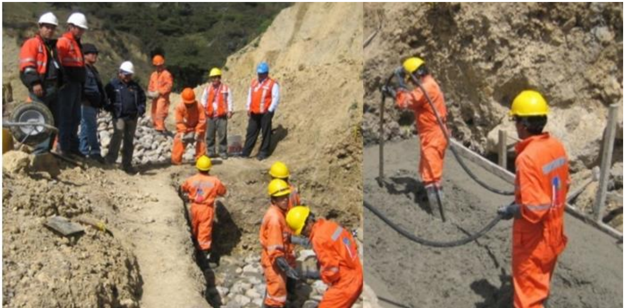
Figura 13. Peligro: Deslizamiento de material suelto y rocas del margen derecho.
