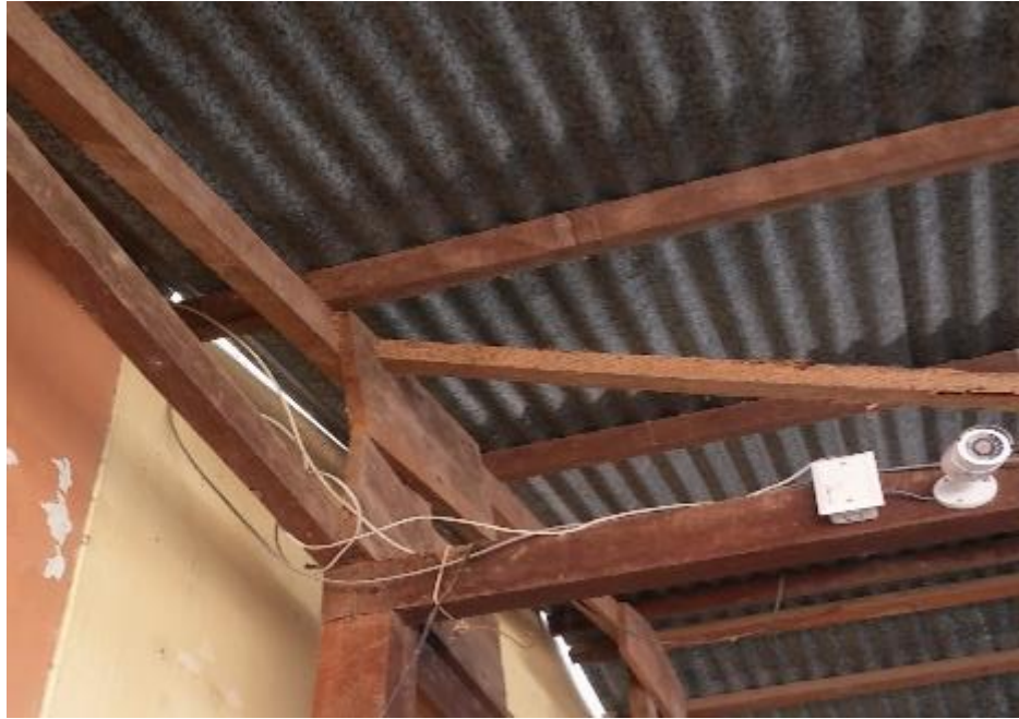
Gráfico 8: Exposición de cableado al aire sin protección Fuente: Municipalidad Distrital de Yarinacocha.
