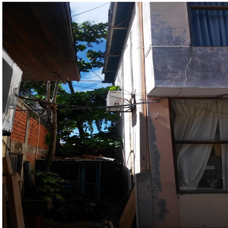
Gráfico 9: Exposición de cableado al aire sin protección Fuente: Municipalidad Distrital de Yarinacocha.
