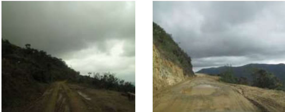
Figura III.1. Situación inicial de la vía en estudio.
