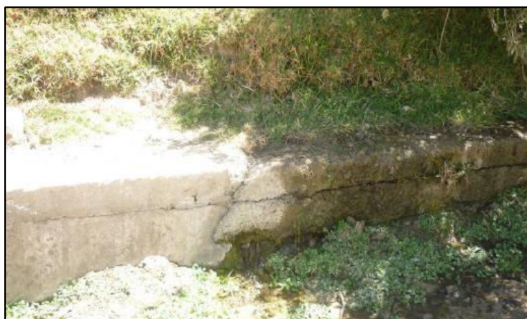
Figura N° 3.3 - Canal de captación fisurado
