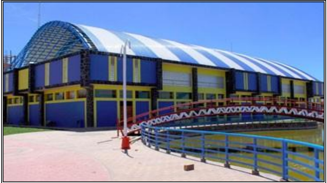
COMPLEJO DEPORTIVO LA CAPILLA.- Se aprecia la falta de conservación y mantenimiento, la humedad de los ladrillos de la parte inferior se viene desintegrando.
