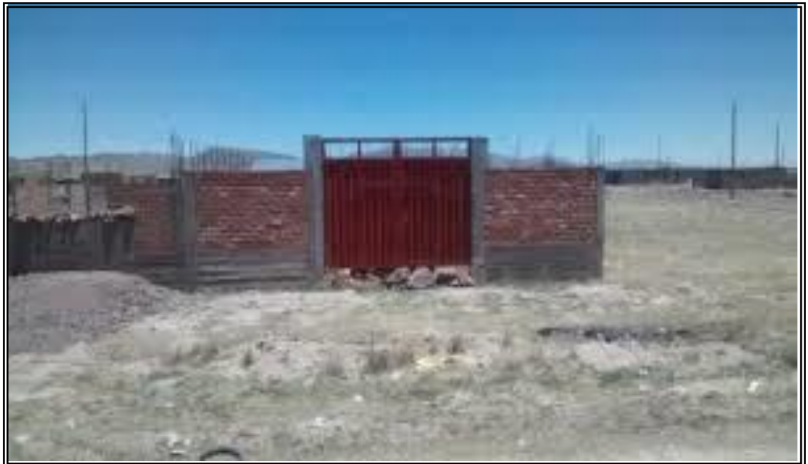
INMUEBLE DE LA AV. HUANCANE.- Se aprecia que los muros de ladrillo están en contacto directo con las veredas y la humedad con facilidad desintegra a los ladrillos, falta conservación y mantenimiento.
