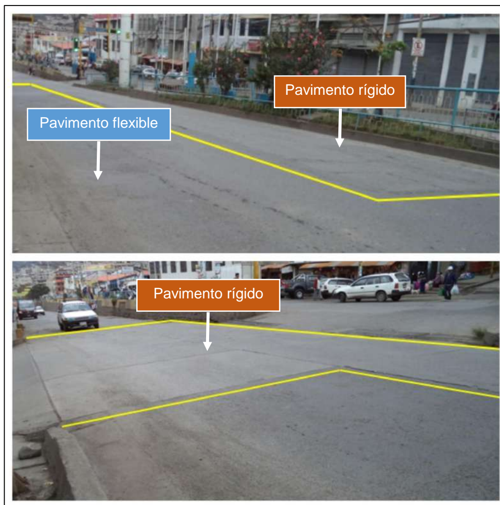
Figura 55. Área delimitada de amarillo, es pavimento rígido y flexible no considerado Fuente. Elaboración propia
