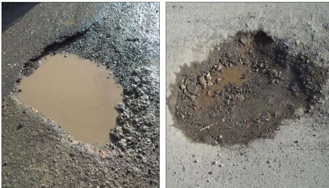
Figura 135. Baches de severidad alto (13H)
