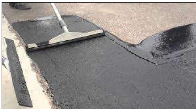
Figura 47. Sello asfáltico superficial localizado
