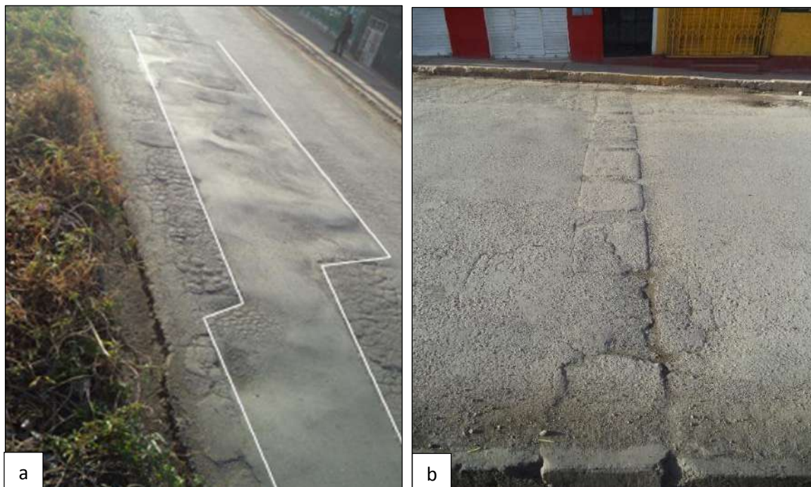
Figura 131. Parches de concreto asfáltico (a) y rígido (b) de severidad alto
