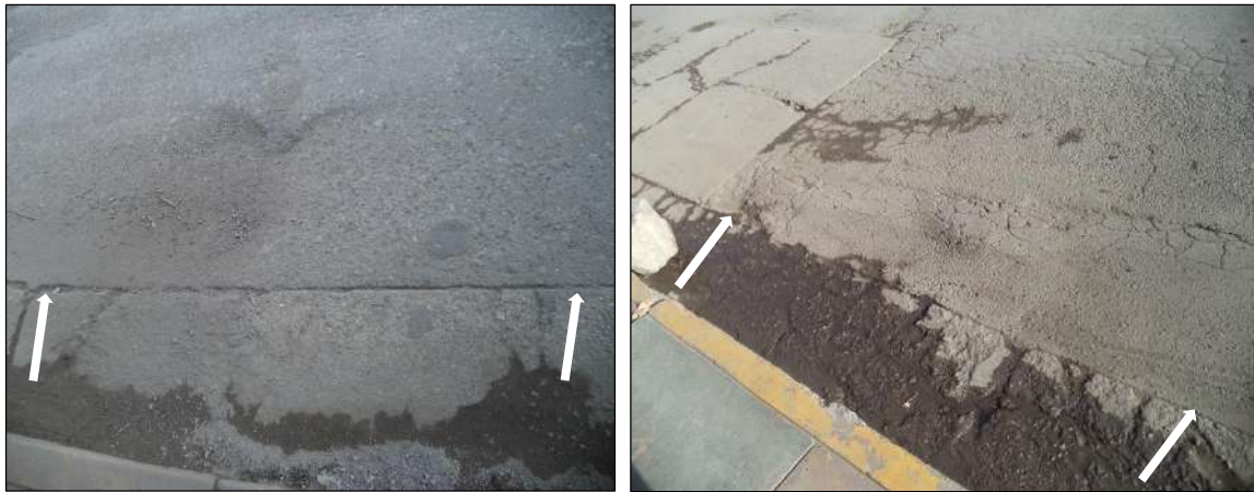
Figura 138. Desplazamiento de severidad bajo (15L)
