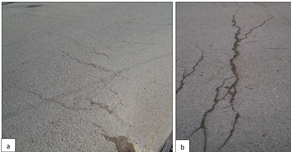
Figura 147. Fisuras en bloque de severidad medio (a), alto (b)
