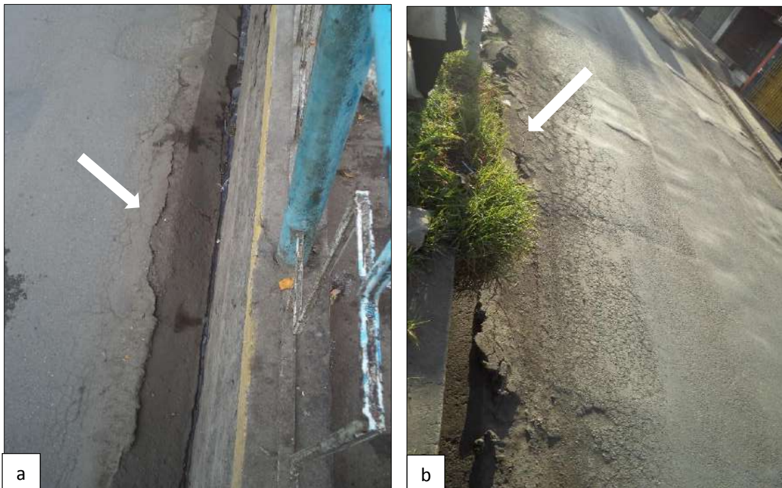
Figura 125. Fisuras en borde de severidad medio (a), alto (b)
