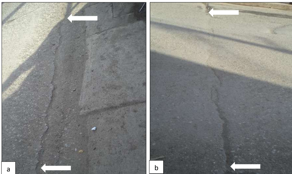
Figura 127. Fisuras longitudinales (a), transversales (b) de severidad medio
