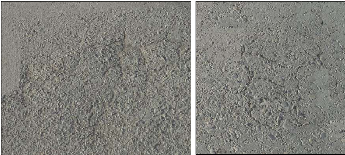
Figura 146. Piel de cocodrilo de severidad bajo
