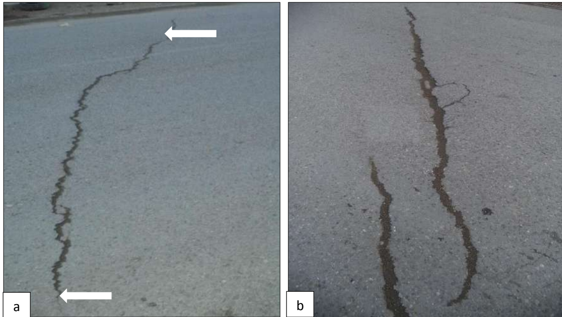
Figura 152. Fisuras transversales de severidad medio (a), alto (b)
