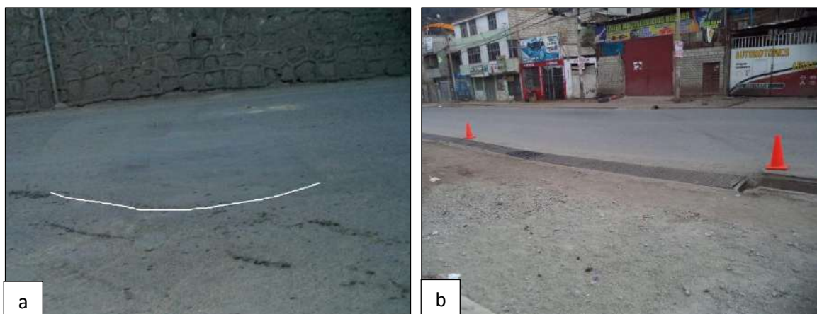
Figura 149. Depresión de severidad bajo (a), alto (b)
