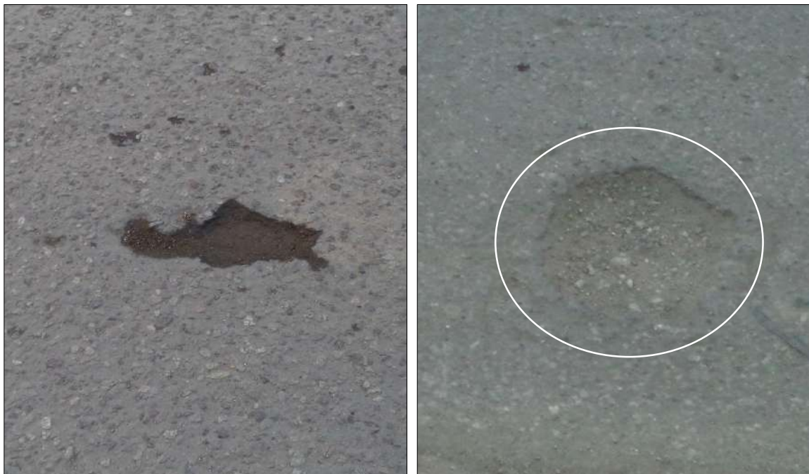
Figura 157. Baches de nivel de severidad bajo
