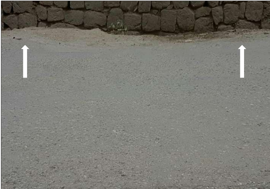
Figura 124. Depresión de severidad alto (5H)
