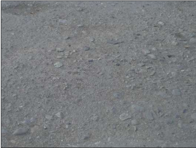
Figura 142. Desprendimiento de agregados de severidad baja (18L)
