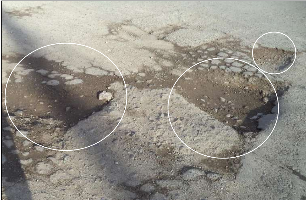
Figura 136. Baches de severidad alto y bajo (13H, 13L)
