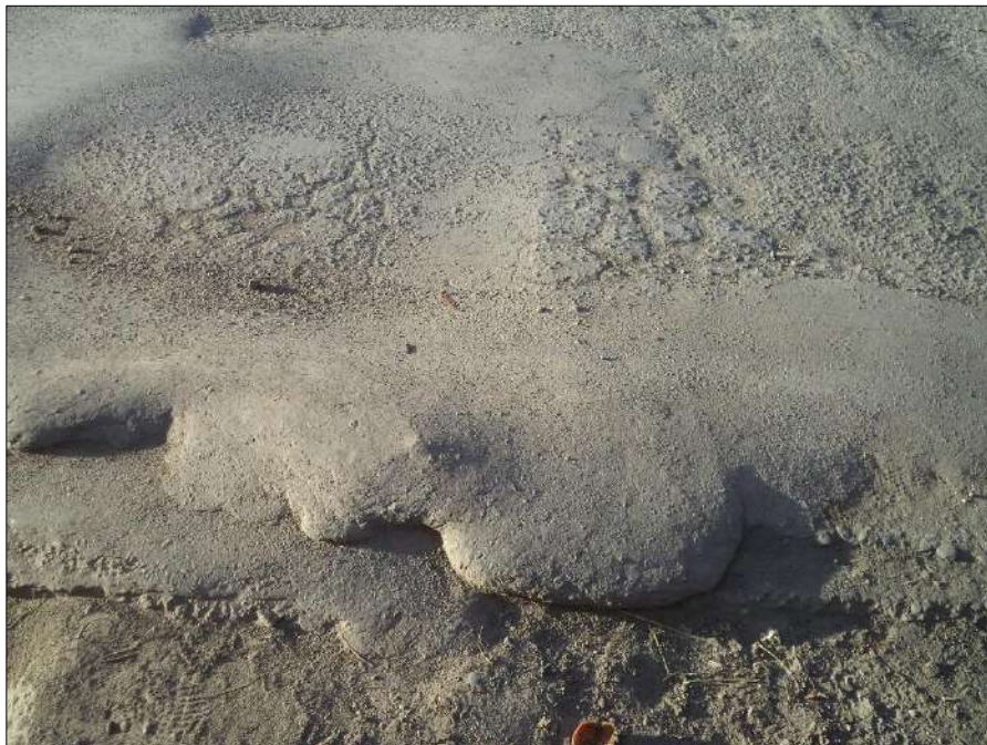
Figura 141. Hinchamiento de severidad alto (17H)
