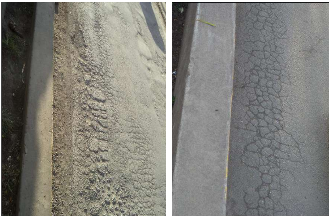
Figura 118. Piel de cocodrilo de severidad alto (1H)
