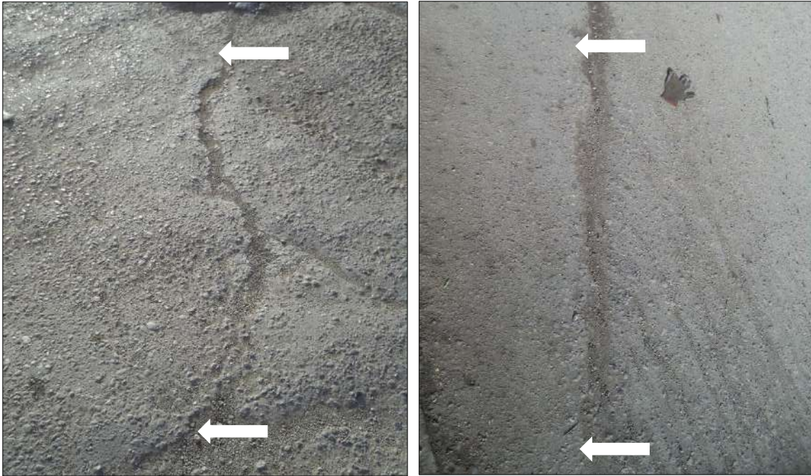
Figura 128. Fisuras longitudinales y transversales de severidad alto
