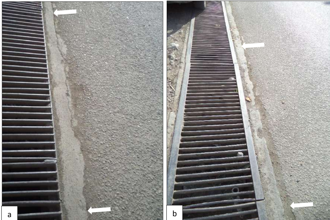
Figura 150. Fisuras en borde de severidad bajo (a), medio (b)
