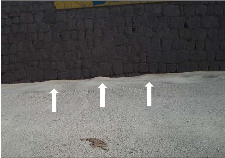
Figura 122. Corrugación de severidad alto (5H)
