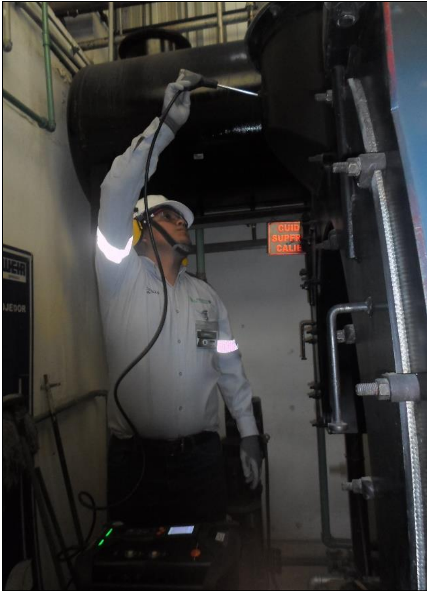
Figura 15: Medición de parámetros de caldero piro-tubular Fuente: Elaboración propia, 2017
