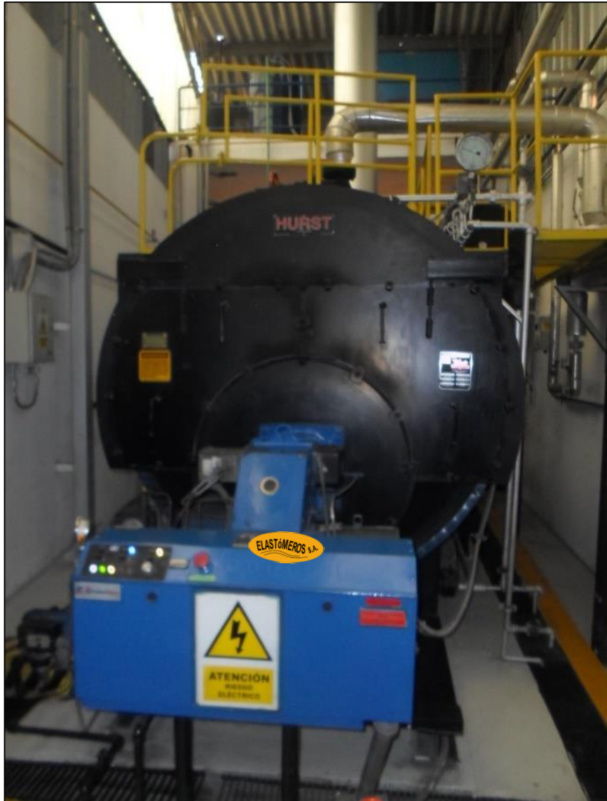
Figura 14: Caldero Hurts de 200 HP de la planta Elastómeros S.A Fuente: Elaboración propia, 2017
