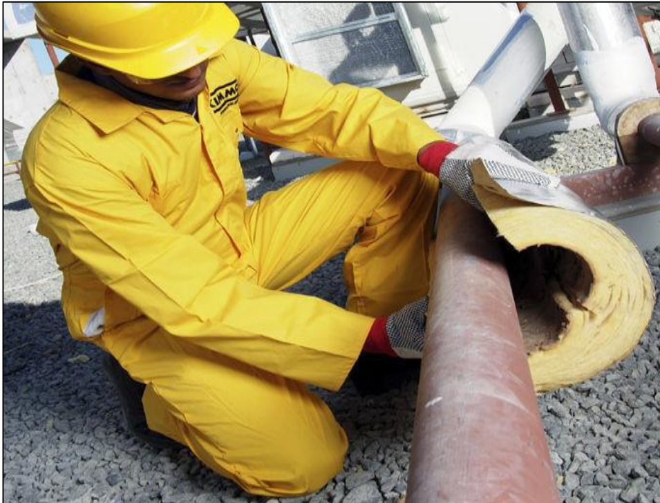
Figura 6: Aislamiento de fibra de vidrio en tuberías de vapor Fuente: Elaboración propia, 2017
