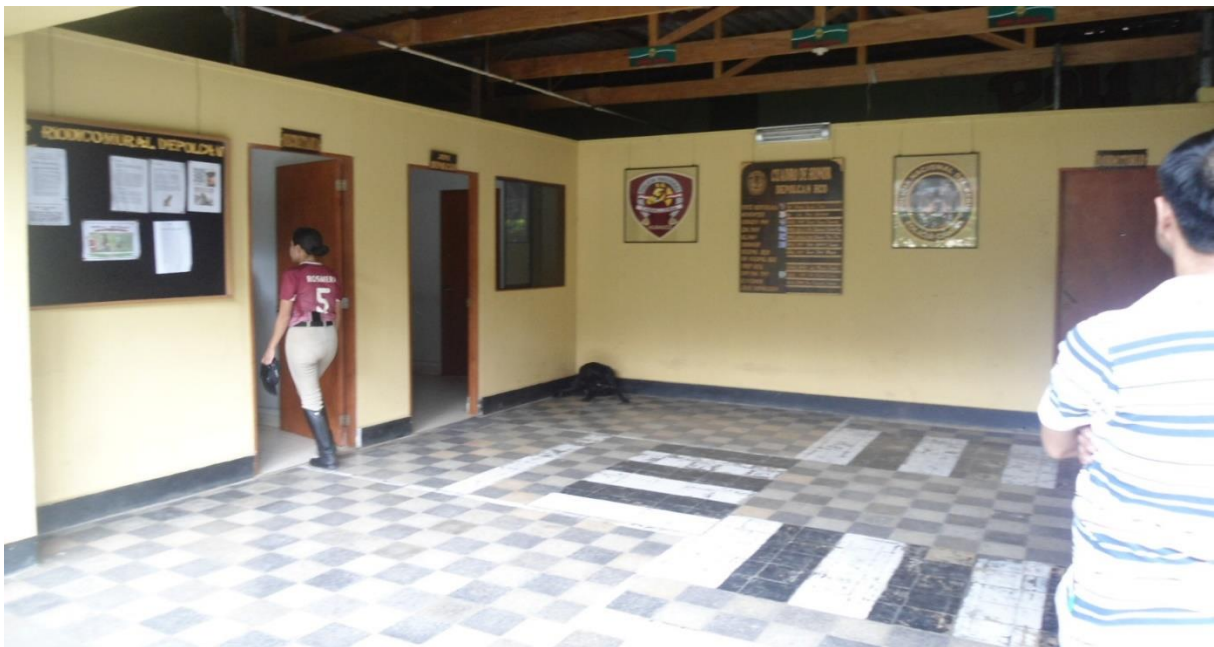
Figura H.16 Las oficinas no tienen cielorraso
