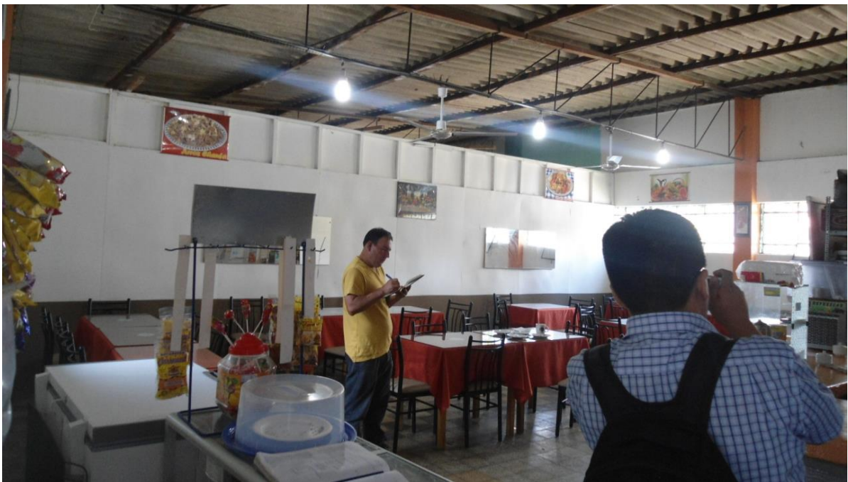
Figura H.10 El comedor no tiene cielorraso y el polvo se filtra por todas las aberturas existentes, y en lluvias hay infiltraciones en todo el ambiente
