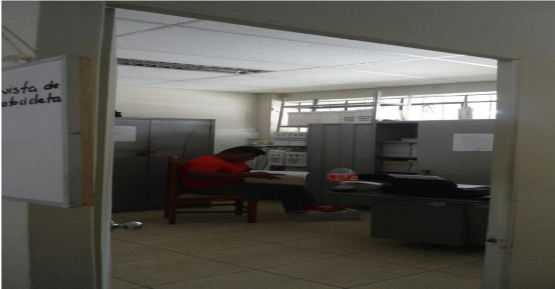
Figura H.13 Oficinas no tienen buena iluminación y ventilación.
