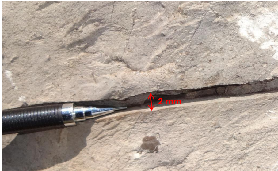
Figura 25 Abertura de la discontinuidad
