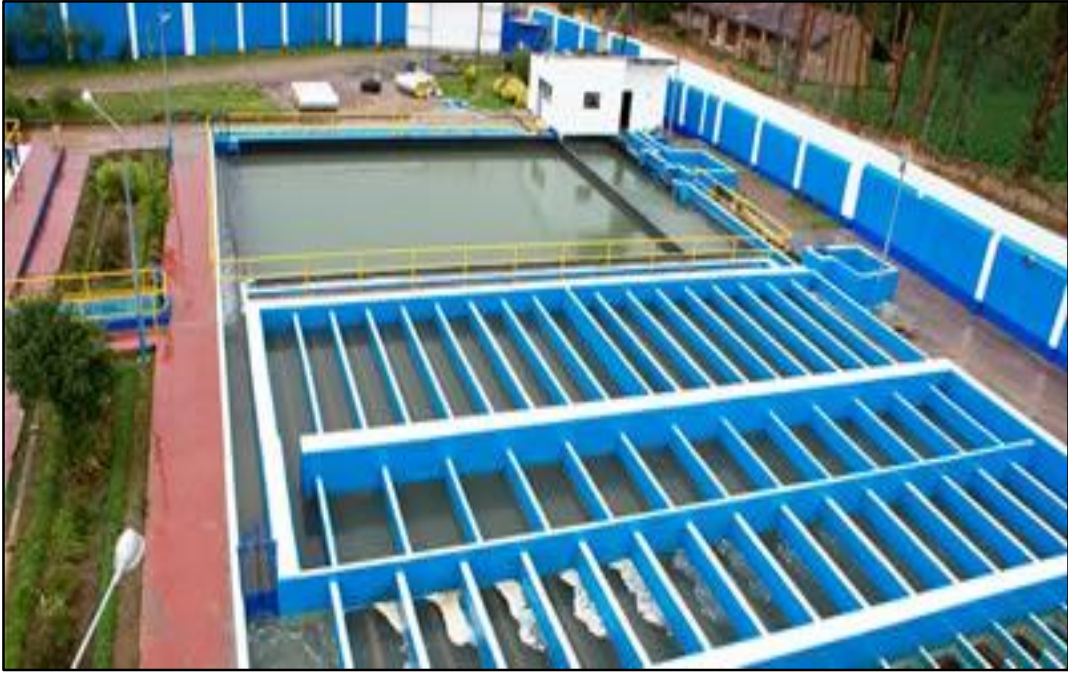
Foto N° 01: P.T.A.P en Vilcacoto - SEDAM Huancayo S.A.(planta antigua)
