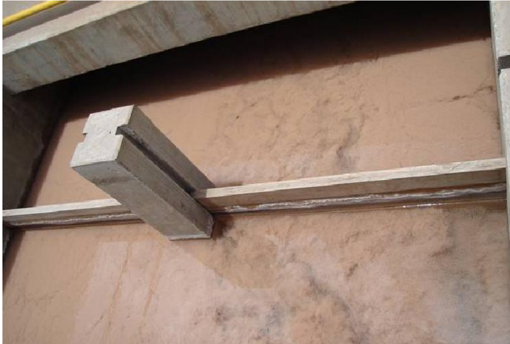
Fig. N°9 Cámara de floculación
