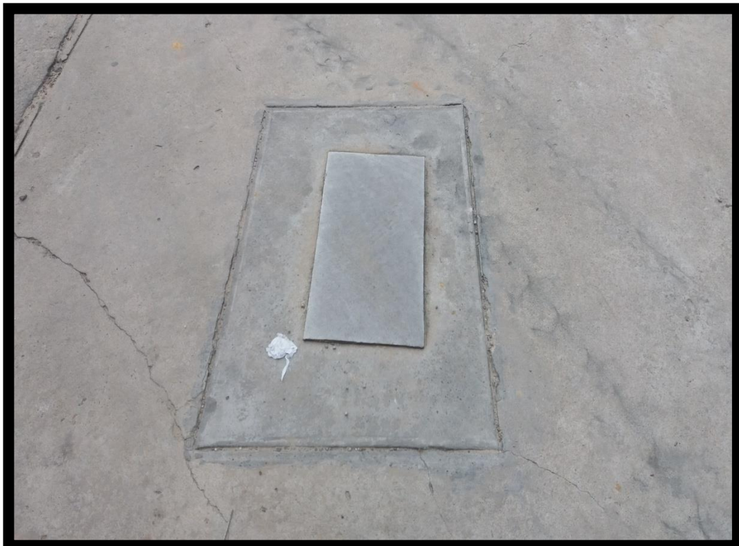
Foto 9: Falta de señalización en el pozo de almacenamiento.
