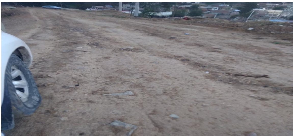
Figura 2: Desgaste superficial por efecto de las lluvias de la carretera circuito cruz de paz
