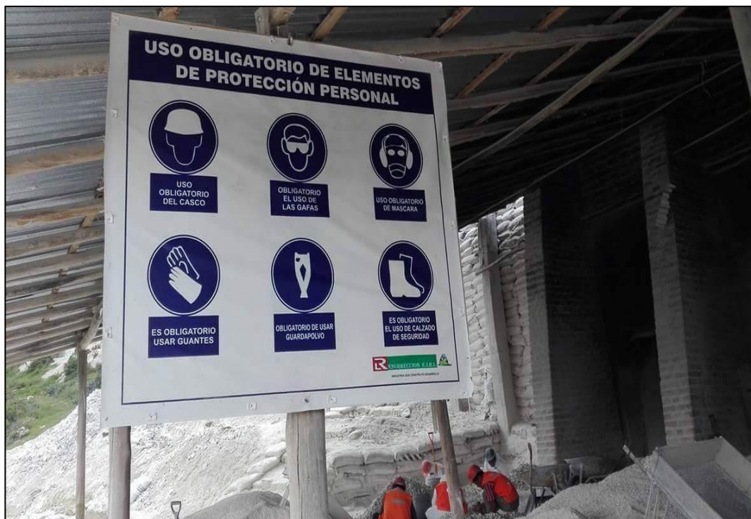
Figura 50: Señalización de uso de EPP dentro del área de trabajo del proyecto – 2016. Fuente: Elaboración propia – 2016.
