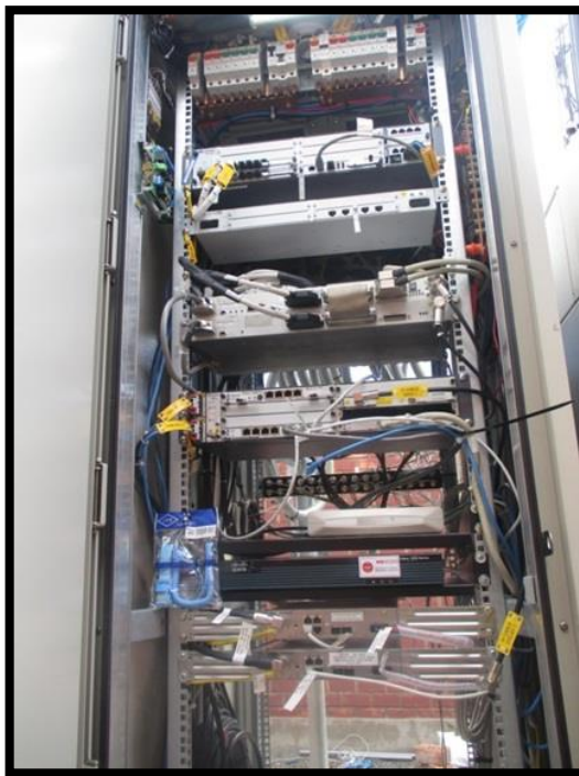
Figura 40. Gabinete de transmisión en la antena de Claro
