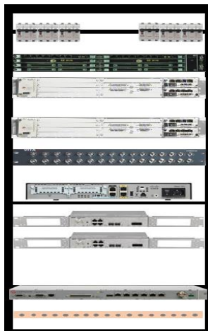
Figura 39. Equipos en el gabinete de TX
