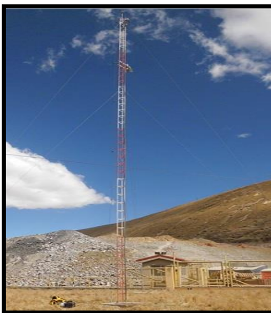
Figura 45. Foto de la antena y torre en el lado SITE cliente San Rafael Minsur
