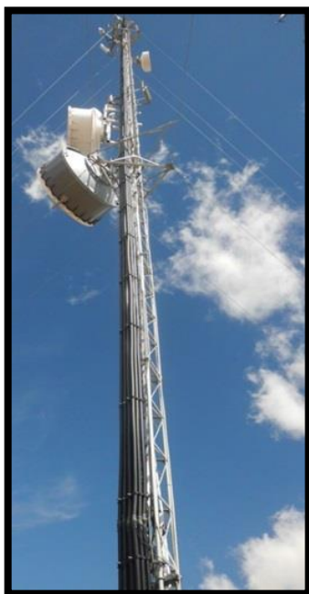
Figura 36. Foto de antena y torre en el lado SITE AP4755 Minsur
