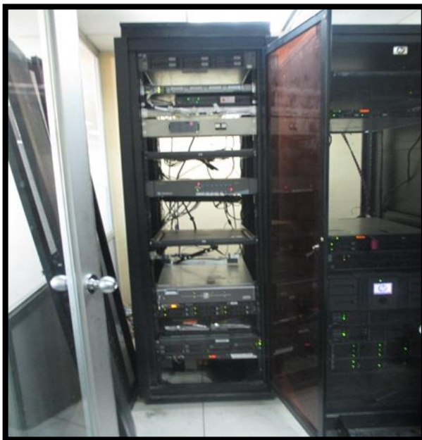
Figura 49. Foto del Datacenter
