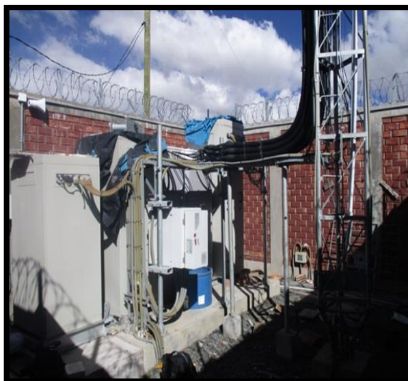
Figura 37. Foto de los gabinetes y base de la torre en el lado SITE AP4755 Minsur
