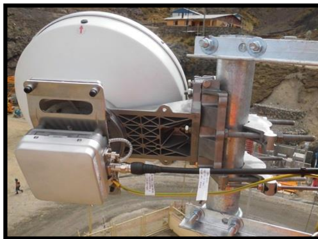
Figura 46. Foto de la antena instalada en el lado cliente San Rafael Minsur
