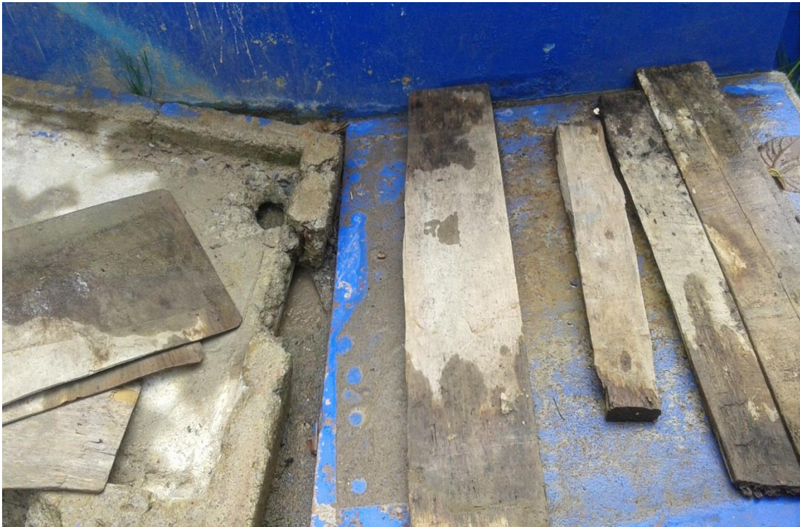
Figura 28.- La captación del manante Mariño es protegido con un trozo de concreto y maderas .
