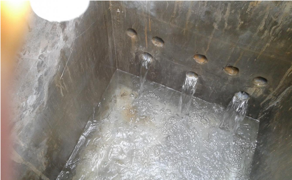
Figura 24.- Estado de la captación del manante Mariño con presencia de sarro alrededor.
