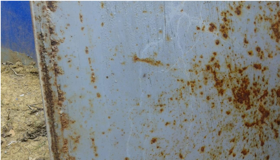
Figura 25.- Estado de la Tapa de la Captación del Manante Mariño que se encuentra oxidada.
