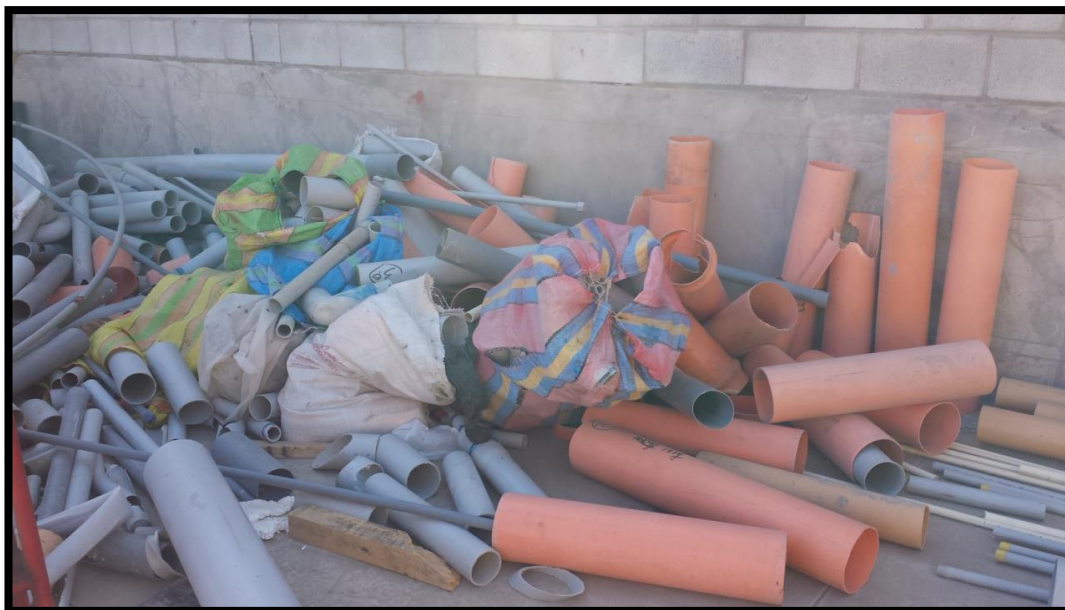
Punto de acopio de residuos de PVC en la Obra Centro Comercial Moquegua
