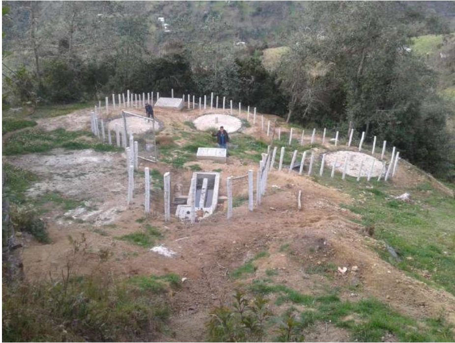
FOTOS DESPUES DE LA CONSTRUCCION Y PUESTA EN FUNCIONAMIENTO DEL NUEVO SISTEMA DE SANEAMIENTO
