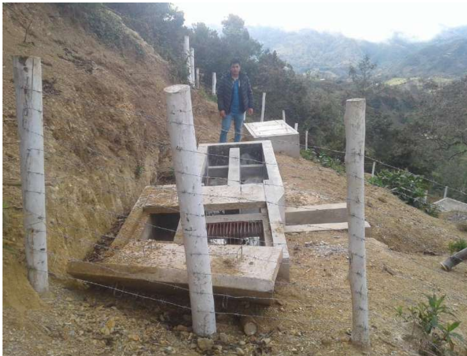
Foto 15: Cámara de rejas y desarenador contruidos y en funcionamiento
