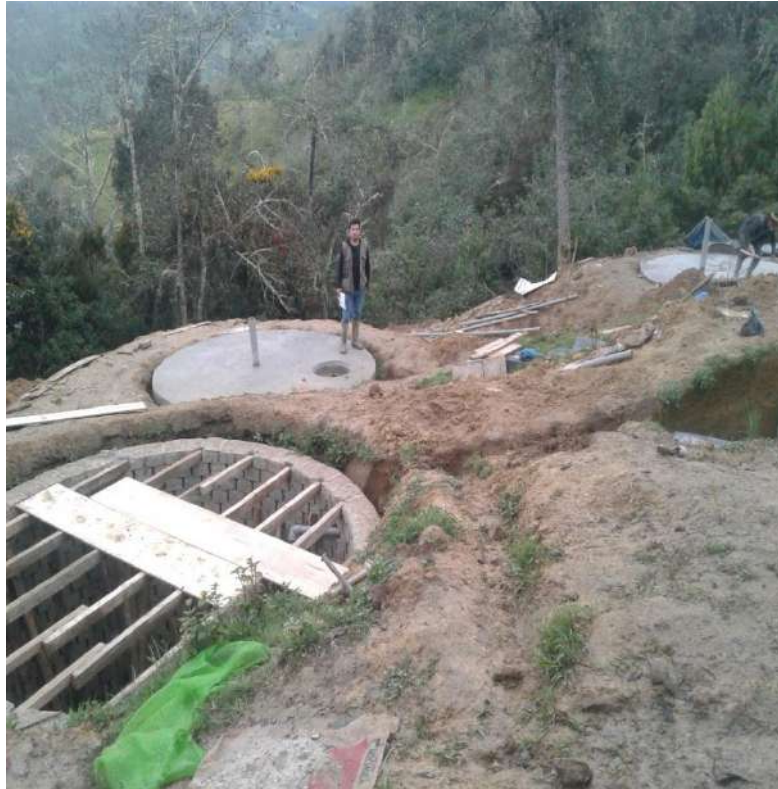
Foto 14: Planta de Tratamiento de Aguas Residuales (PTAR)
