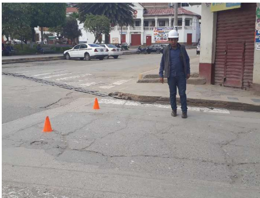
Fotografía 2: Se puede observar una patología que es losa dividida con nivel de severidad H.
