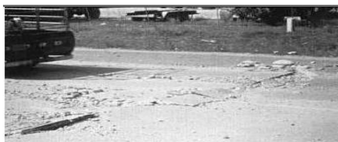
Figura 3: Rotura por pandeo de severidad media.
