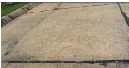
Figura 23: Grieta Lineal de gravedad baja
