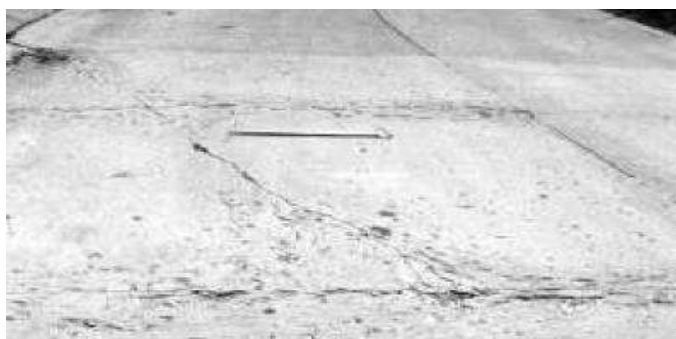
Figura 13: Grieta De Durabilidad “D” de gravedad alta.
