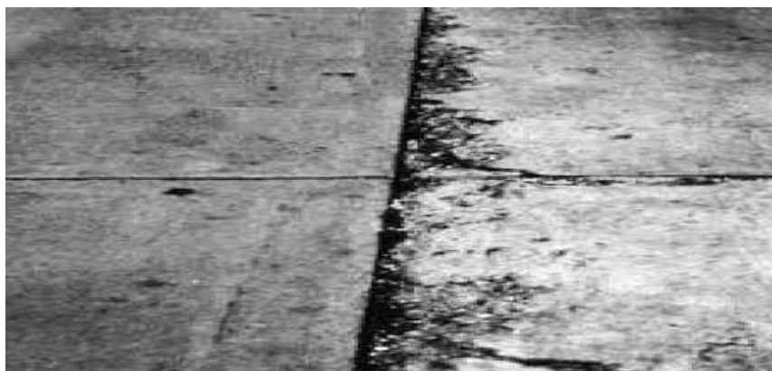
Figura 49: Desportilladura De Junta de gravedad media.
