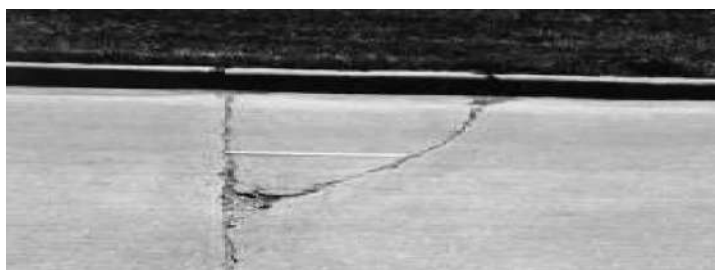
Figura 6: Grieta de esquina de gravedad media.
