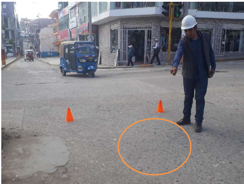
Fotografía 7: Se puede observar una patología que es punzonamiento con nivel de severidad M.
