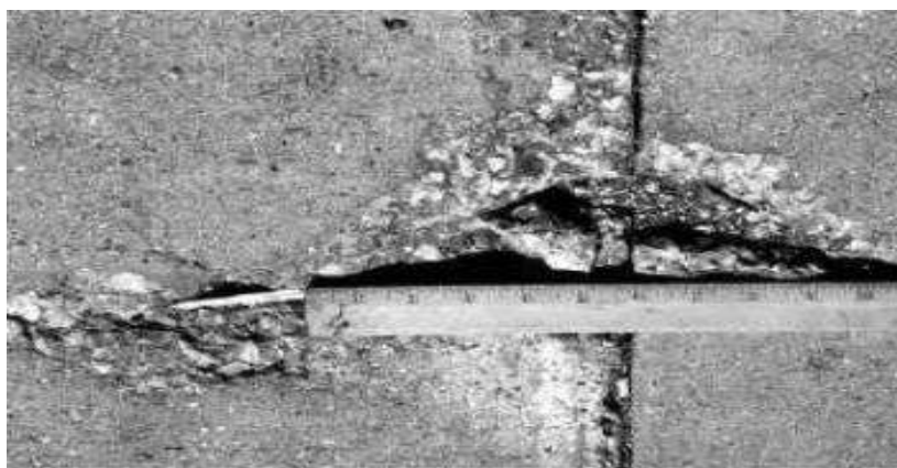
Figura 46: Desportilladura De Esquina de gravedad medio.
