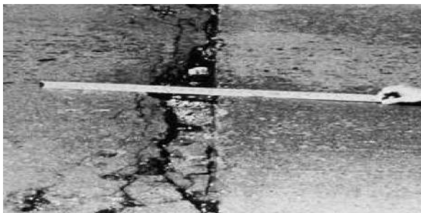
Figura 50: Desportilladura De Junta de gravedad alta.
