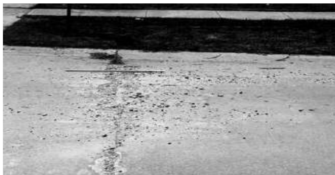
Figura 2: Rotura por pandeo de severidad baja.
