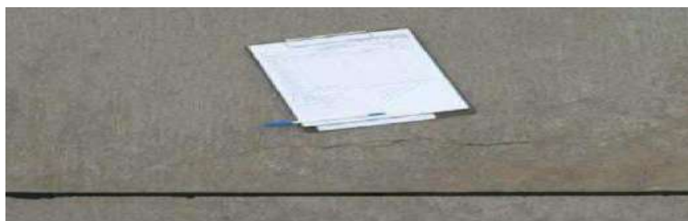
Figura 44: Grietas De Retracción.
