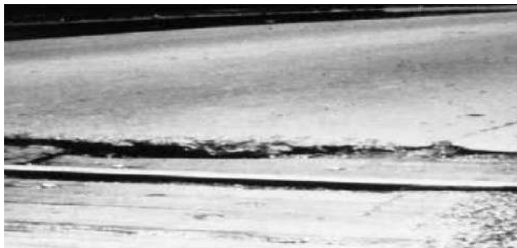
Figura 40: Cruce De Vía Férrea de gravedad alta.
