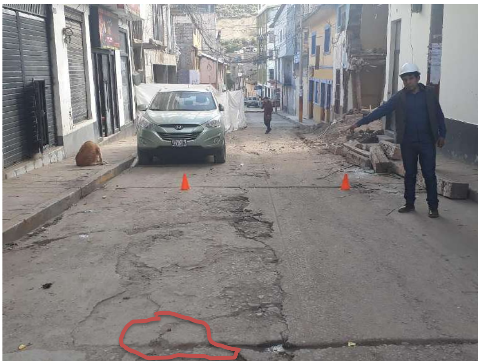
Fotografía 8: Se puede observar una patología que es desportilladura de junta con nivel de severidad M.
