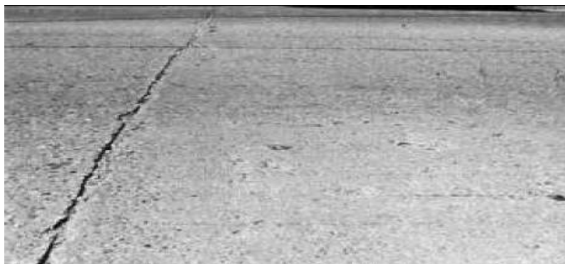
Figura 48: Desportilladura De Junta de gravedad bajo.
