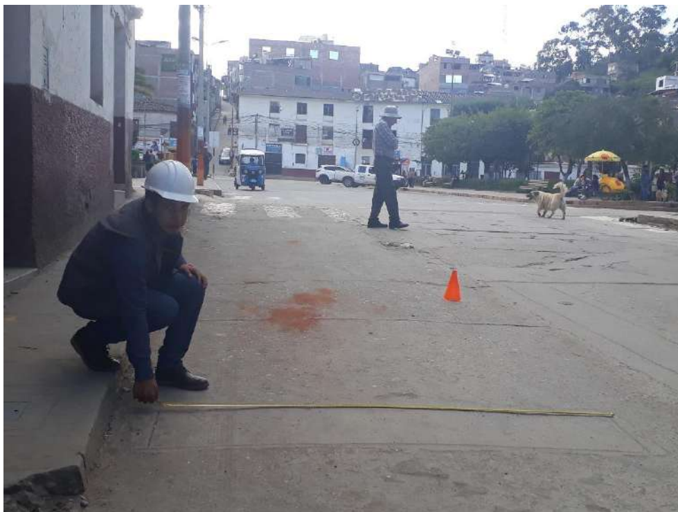
Fotografía 3: Se puede observar una patología que es el parcheo grande con nivel de severidad L.
