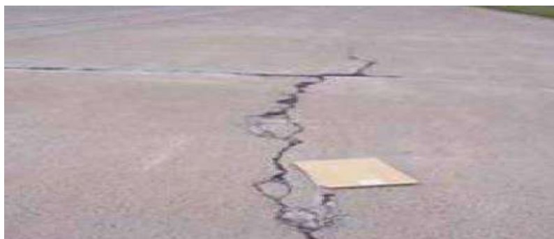
Figura 25: Grieta Lineal de gravedad alta.
