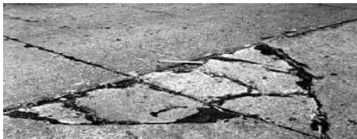
Figura 7: Grieta de esquina de gravedad alta.
