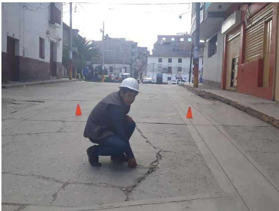
Fotografía 4: Se puede observar una patología que es la grieta lineal con nivel de severidad H.
