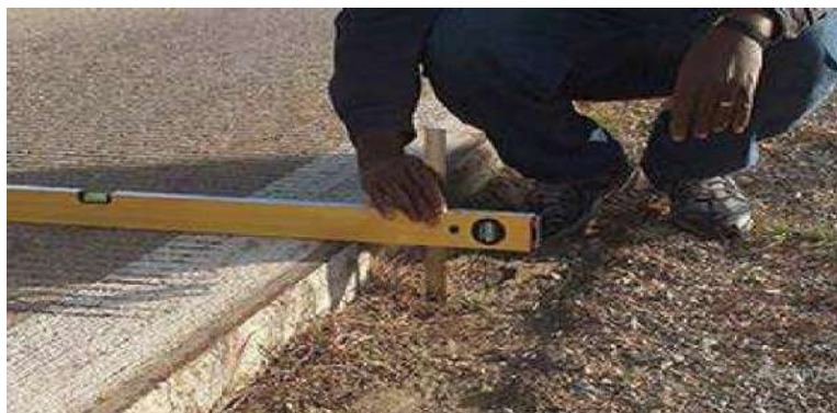
Figura 22: Desnivel Entre Carril y Berma de gravedad alta.
