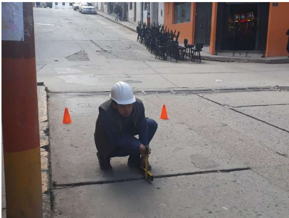
Fotografía 5: Se puede observar una patología que es escala con nivel de severidad M.
