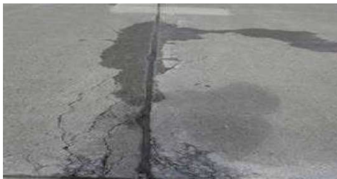
Figura 12: Grieta De Durabilidad “D” de gravedad media.
