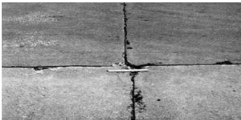
Figura 45: Desportilladura De Esquina de gravedad bajo.
