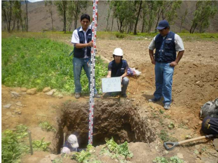
Fig.41. Vista fotográfica de la exploración de suelo (calicata C-1). Dimensiones de la excavación 1.50mt x 1.50mt, hasta una profundidad de 3.50m. (Fuente: "ANTEPROYECTO SUB ESTACION AMARILIS", INFORME DEL ESTUDIO GEOLÓGICO, GEOTÉCNICO Y DE MECANICA DE SUELOS, LABORATORIO DE SUELOS Y ASFALTO "LA PIRÁMIDE" E.I.R.L.)p.10.
