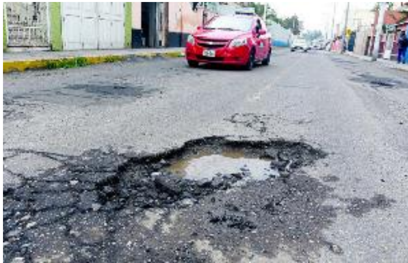
Lluvias que Deterioran las Vías del Distrito de Paucarpata
