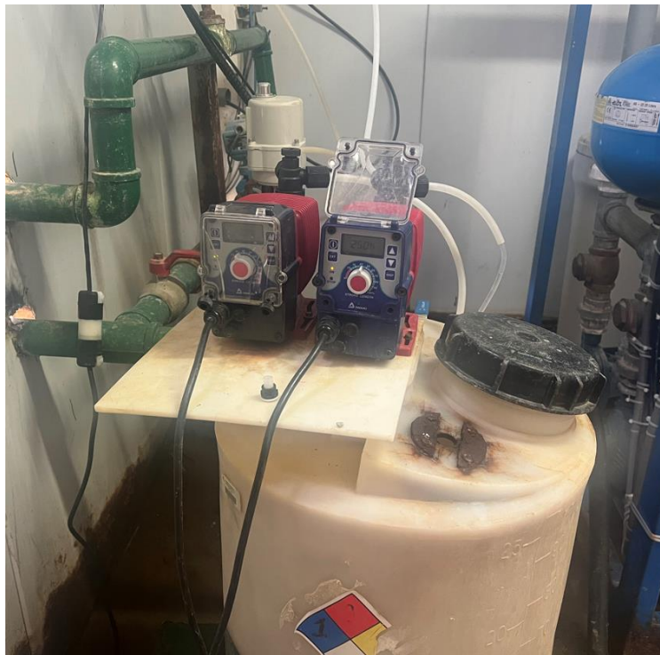
Sistema de Cloración del Agua
