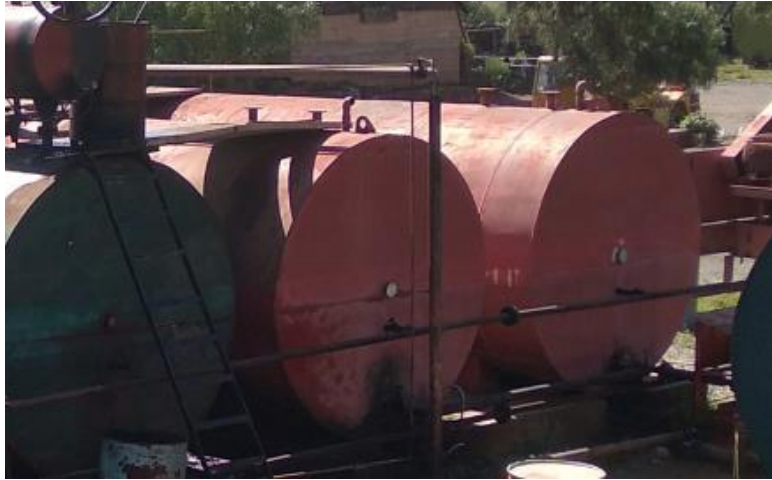
Gráfico 15 Tanque de Asfalto
