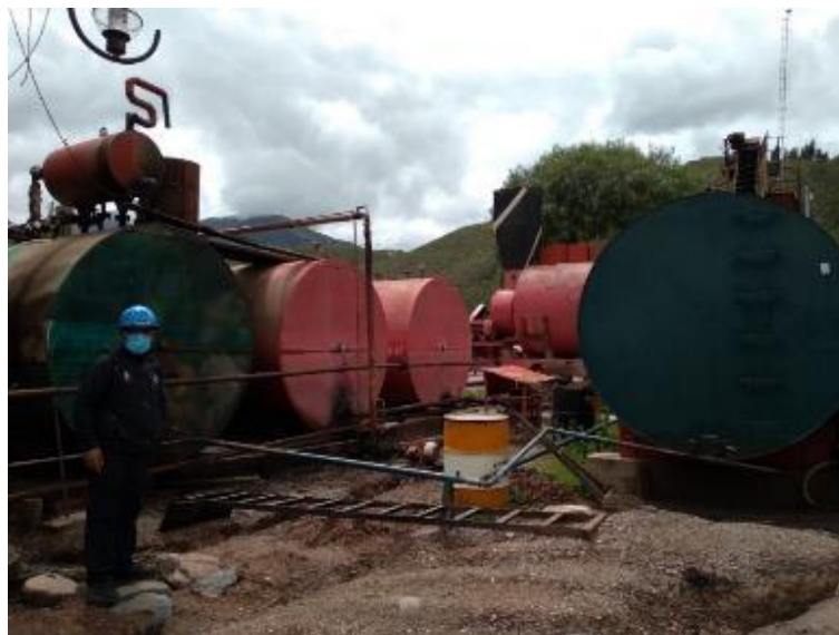
Planta de Calentamiento de Asfalto
