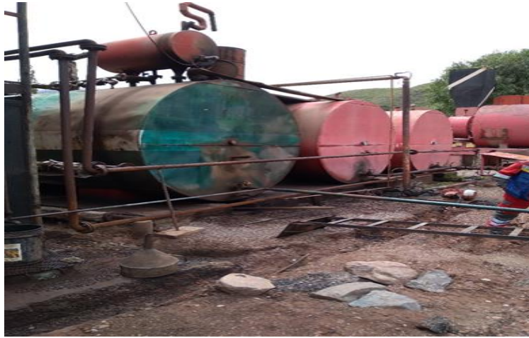
Tanque de Almacenamiento de Asfalto del GORE Cusco
