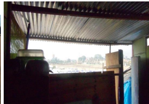
Fotografía 04. Inadecuado criterio de diseño ambiental.
