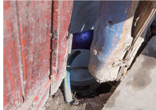
Fotografía 02. Inadecuada estabilidad estructural de la vivienda.
