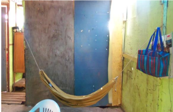
Fotografía 01. Inadecuada estabilidad estructural de la vivienda.
