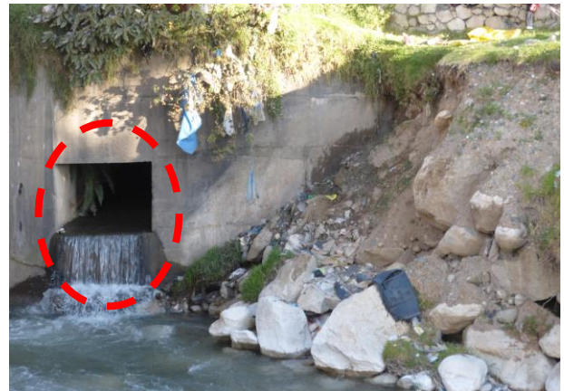
Imagen I-08: aguas servidas que desemboca en el río Fuente: Propio.
