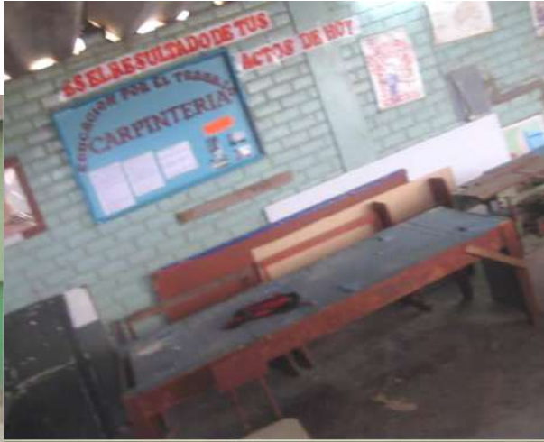
FOTOGRAFÍA F-14: Taller de carpintería opcional en desuso por inadecuadas condiciones. Fuente: Inspección al local N. Yauri (Año: 2016)
