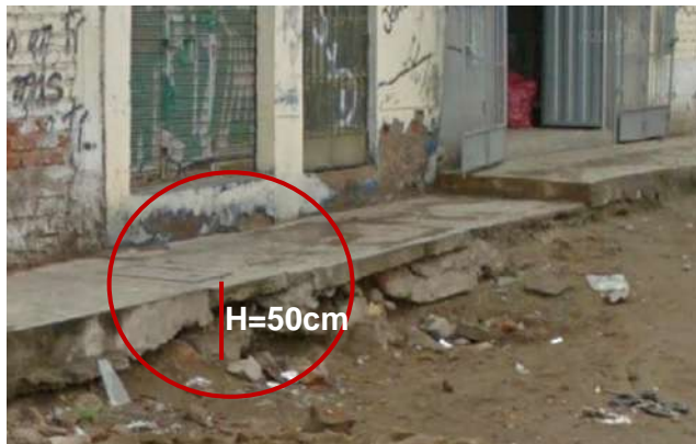
FOTOGRAFÍA F-01: Inadecuadas condiciones de las vías peatonales Fuente: Inspección al lugar N. Yauri (Año: 2017)
