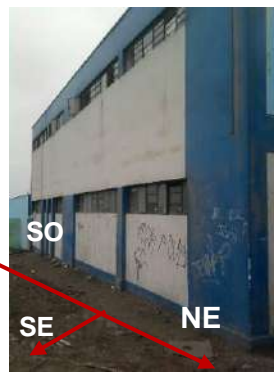
FOTOGRAFÍA F-16: Poca iluminación ingresa al bloque de sec., ya que estas ventanas están orientadas al SE. Fuente: Inspección al local N. Yauri (Año: 2016)
