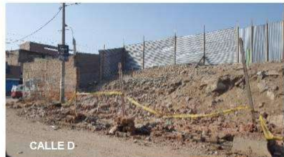
FOTOGRAFÍA F-09: Muro de la calle C se cayó debido a la acumulación de desmonte que se apoya en él. Fuente: Inspección al lugar N. Yauri (Año: 2017)
