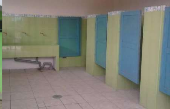
FOTOGRAFÍA F-19: Red desagüe expuesto en los lavaderos y las puertas muy altas. Fuente: Inspección al local N. Yauri (Año: 2017)
