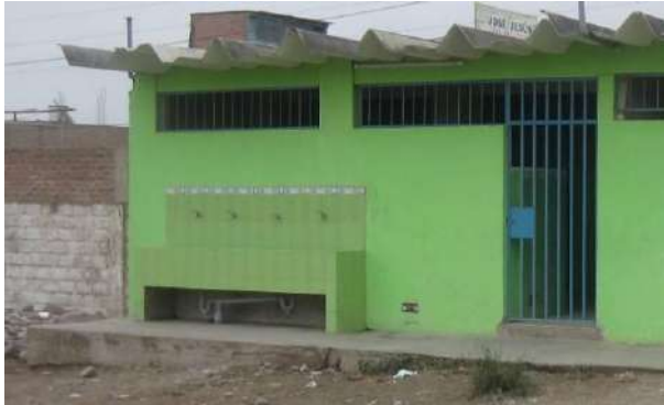
FOTOGRAFÍA F-18: Inadecuado acceso a los servicios higiénicos, tuberías expuestas. Fuente: Inspección al local N. Yauri (Año: 2017)
