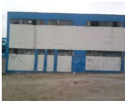
FOTOGRAFÍA F-15: Ventanas posteriores de 0.80cm de altura. Fuente: Inspección al local N. Yauri (Año: 2016)
