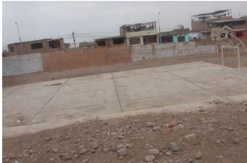
FOTOGRAFÍA F-23: Losas deportivas rodeadas de desmonte Fuente: Inspección al local N. Yauri (Año: 2016)
