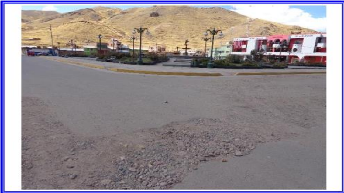
DESCRIPCION : SE OBSERVA EL DETERIORO DEL PAVIMENTO FLEXIBLE EN EL JIRON ATAHUALPA CON JIRON SINCHI ROCA.
