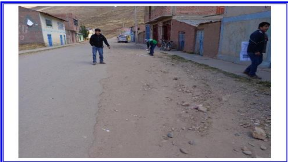
DESCRIPCION : CUADRA 01 DEL JIRON SINCHI ROCA PAVIMENTO FLEXIBLE DETERIORADO.
