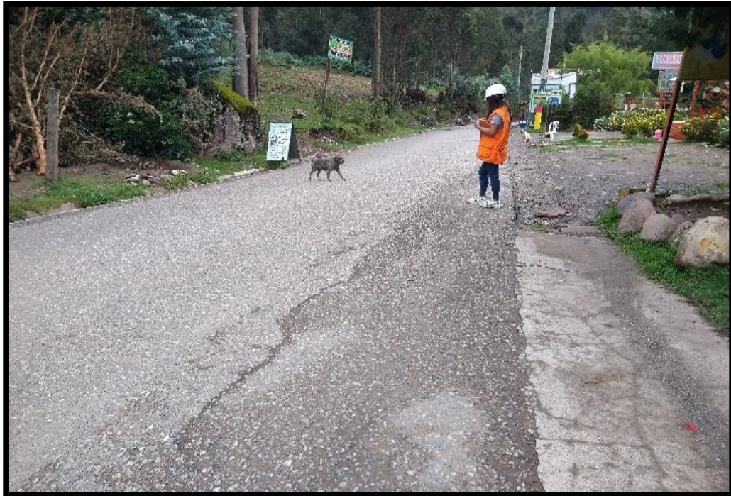
Foto 8. Se observa fallas por fisura longitudinal.
