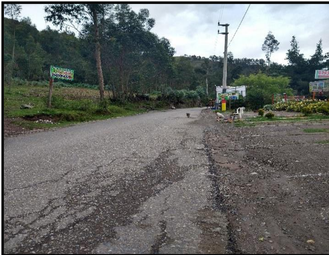
Foto 11. Se observa en la imagen el tipo de falla por piel de cocodrilo.
