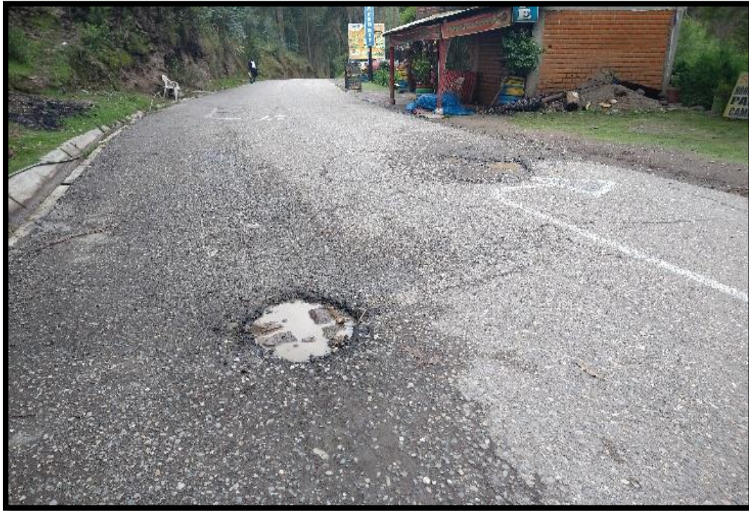
Foto 12. Vista previa de una de las fallas en hueco, que presenta la vía.
