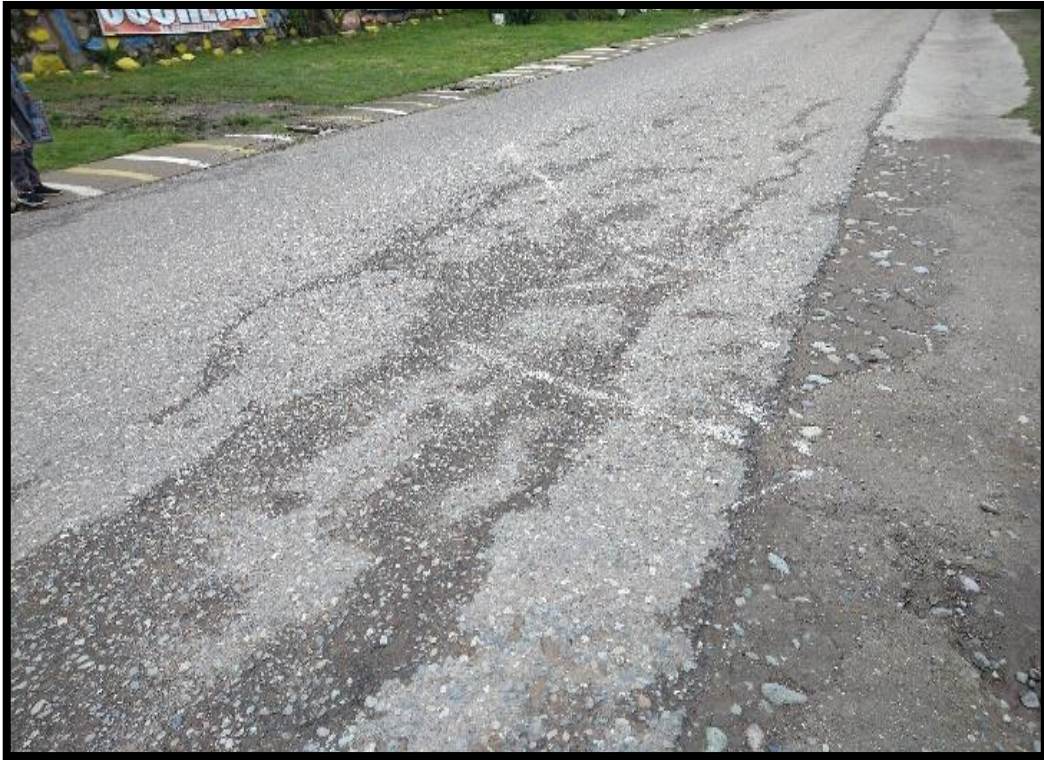
Foto 10. Se observa un tramo de la vía donde se encuentra falla por desprendimiento de agregado.
