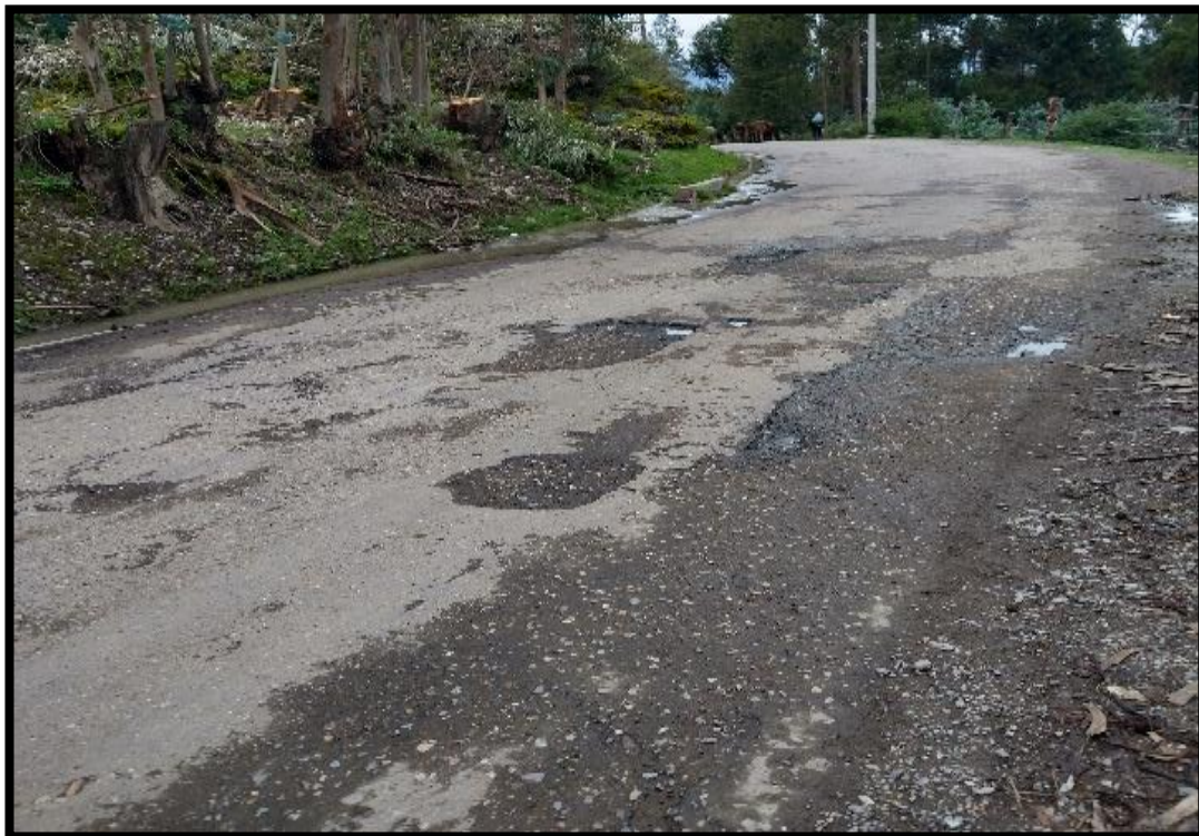
Foto 13. Se observa la imagen el desprendimiento del agregado, por el paso de los años, también podemos observar ahuellamientos
