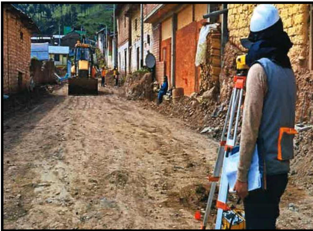
FOTO N° 4 Nivelación y plantillado de la vía para la construcción de las pistas y veredas
