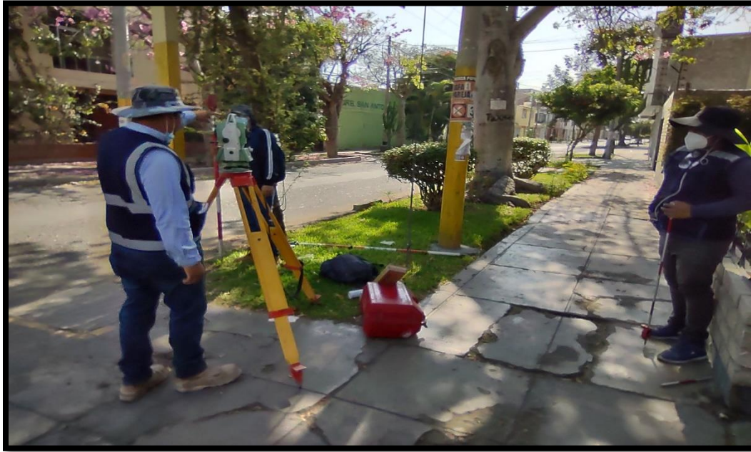
INICIO DEL TRABAJO EN CAMPO EN CALLE SAN PABLO FERDANDINI CON LA AV. SAN MARTIN
