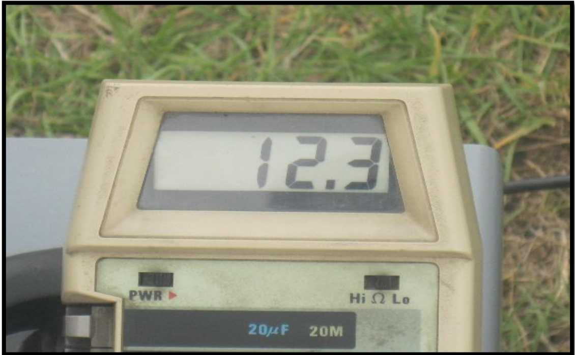
Foto N° 3. Verificando la operatividad del Sistema Fotovoltaico con todos los equipos debidamente instalados
