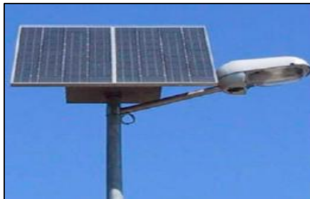
Figura Nº 16: Iluminación pública con paneles solares.
