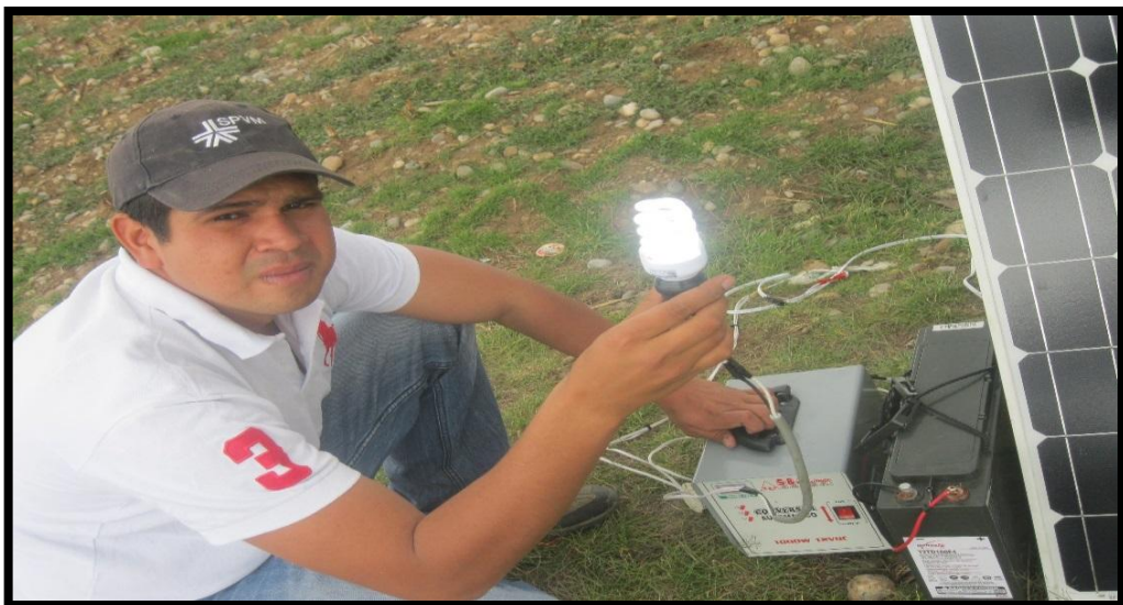
Foto N° 4: Verificando la operatividad del Sistema Fotovoltaico con todos los equipos debidamente instalados
