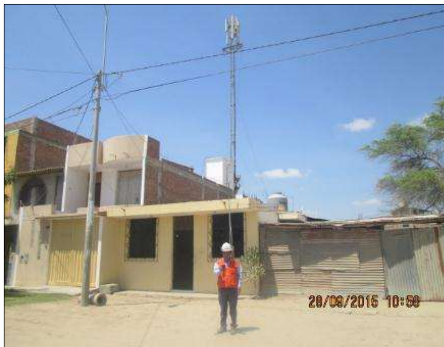
Imagen N° 05: Torre Metálica y Antenas
