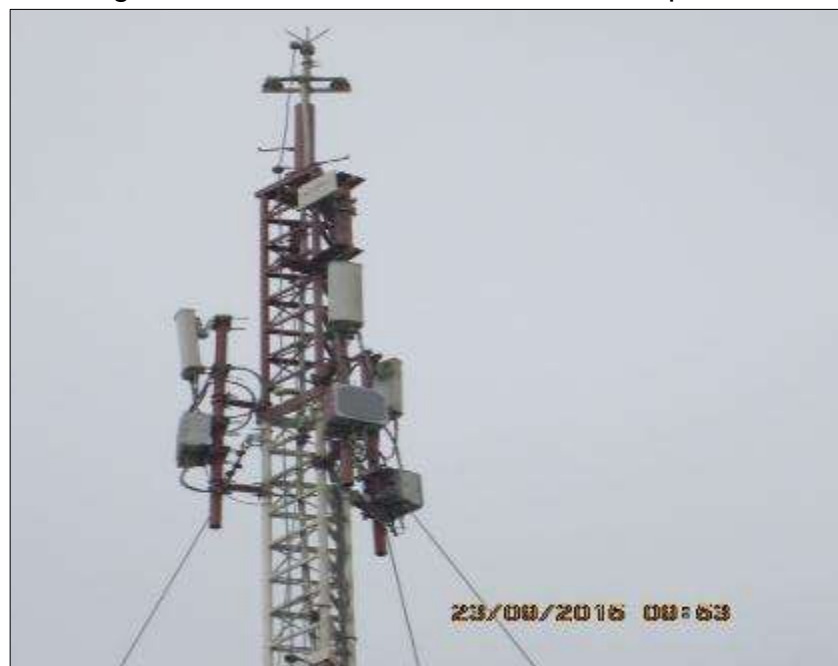
Imagen N° 09: Torre Metálica con sus Templadores
