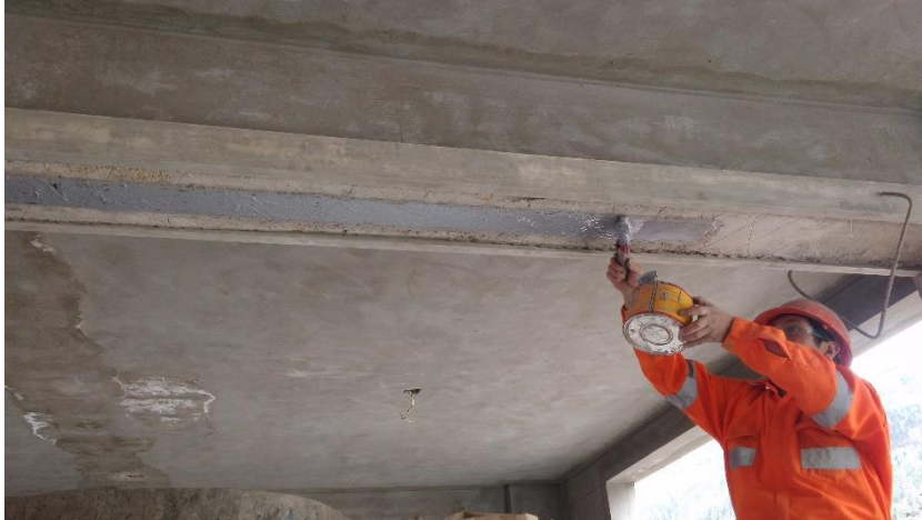
Figura 27 Aplicando el epóxico en la zona donde se colocara la fibra de carbono
