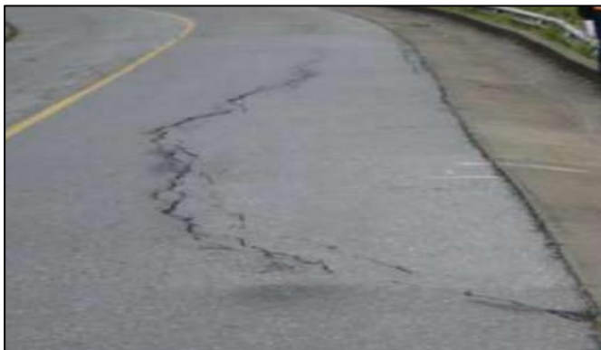
Imagen N°06: Fisuras en arco
