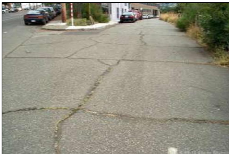
Imagen N°10: Fisuras por reflexión de junta.
