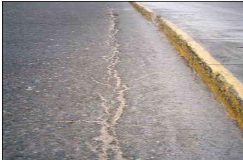
Imagen N°09: Fisuras de borde.
