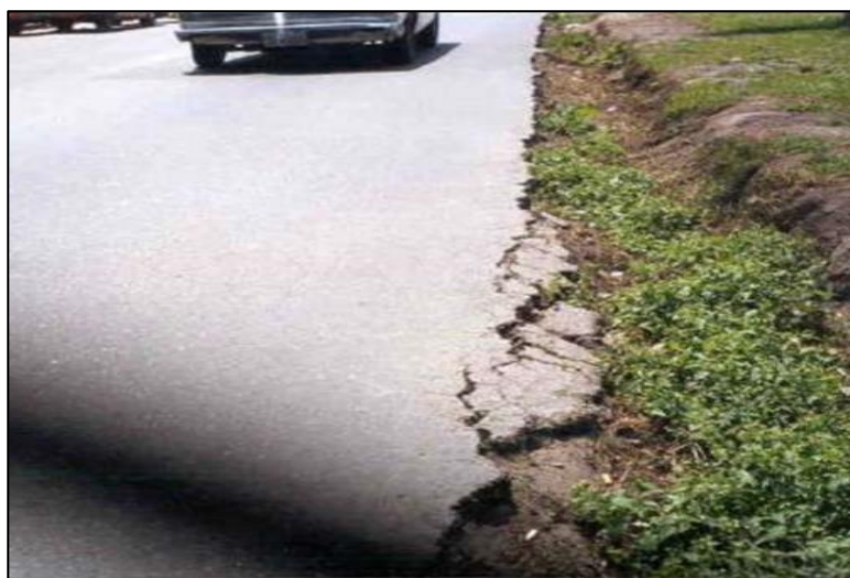
Imagen N°16: Desintegración de bordes.
