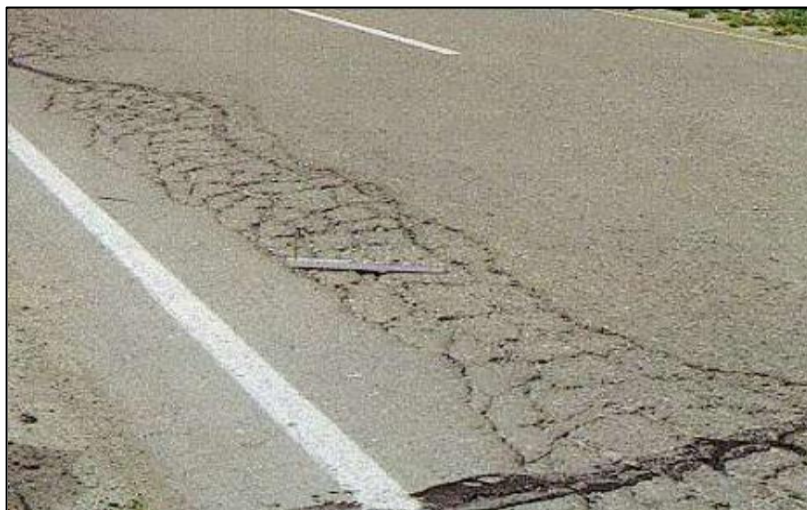
Imagen N°04: Fisuras piel de cocodrilo.
