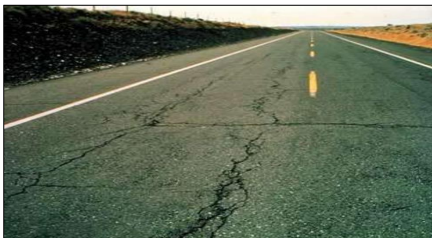
Imagen N°05: Fisuras en bloque.
