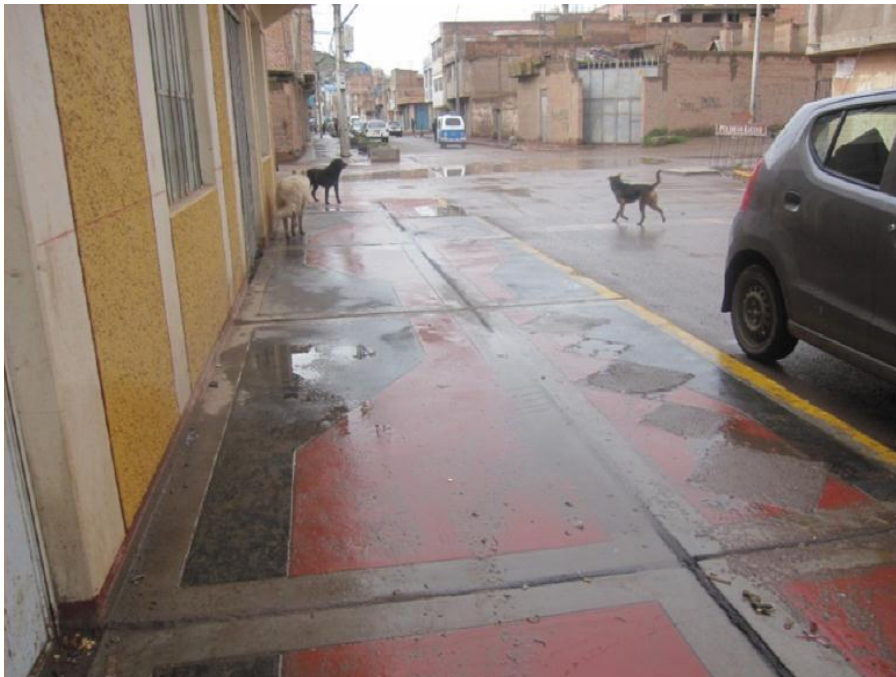
FOTOGRAFÍA N° 12: Se observa la falta de obras de drenaje. Jr. Nicolás Jarufe – Juliaca.
