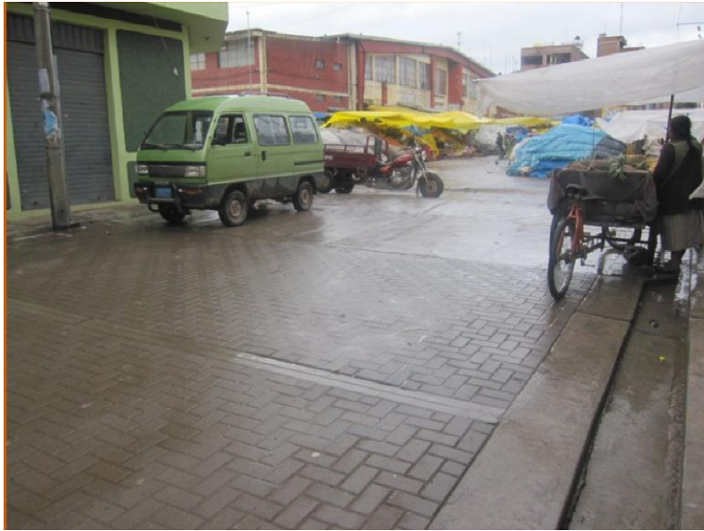
FOTOGRAFÍA N° 1: Se observa las características de un pavimento segmentado en el Jr. Nicolás Jarufe – Juliaca.
