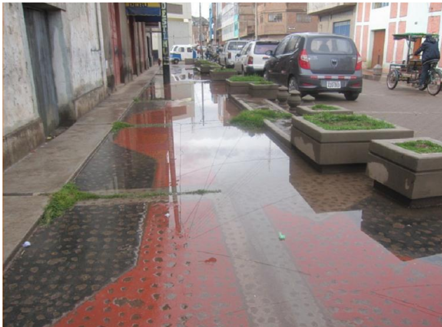
FOTOGRAFÍA N° 9: Se observa la deficiencia de pendientes lo que ocasiona considerable estancamiento de agua. Jr. Nicolás Jarufe – Juliaca.
