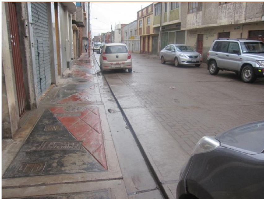
FOTOGRAFÍA N° 4: Se observa las obras de drenaje con funcionamiento deficiente. Jr. Nicolás Jarufe – Juliaca
