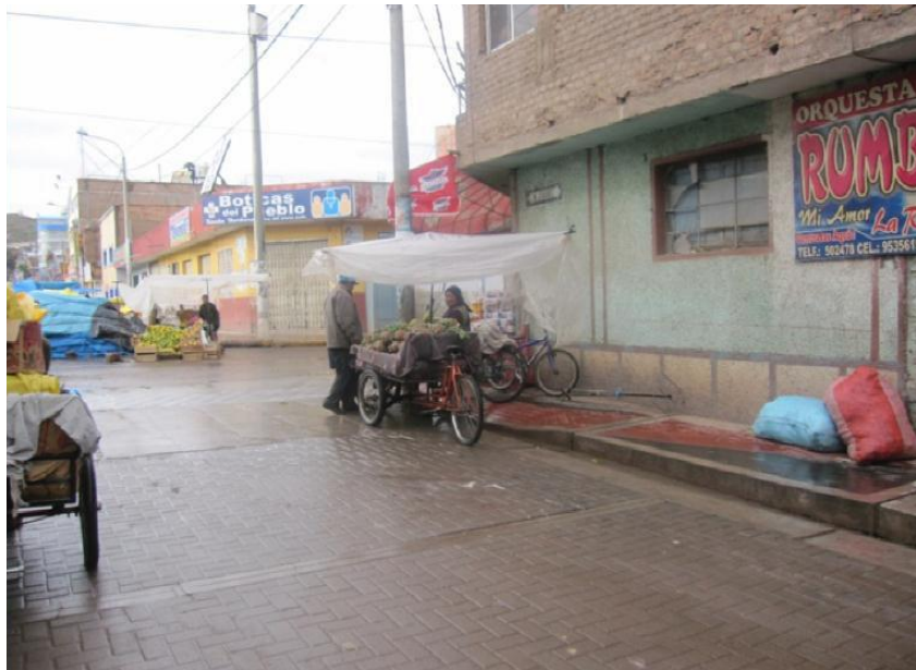
FOTOGRAFÍA N° 2: Se observa dificultades en el drenaje en la intersección de vías. Jr. Nicolás Jarufe – Juliaca.
