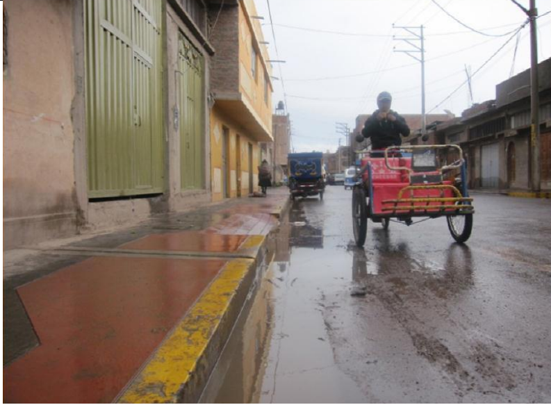
FOTOGRAFÍA N° 13: Se observa el estancamiento de agua en la obra de drenaje. Jr. Nicolás Jarufe – Juliaca.
