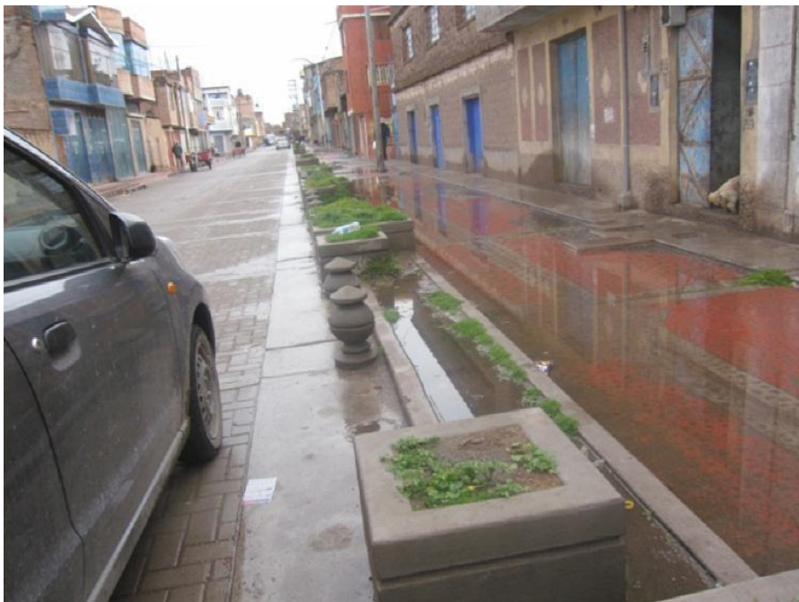
FOTOGRAFÍA N° 8: Se observa la deficiencia de pendientes lo que ocasiona considerable estancamiento de agua. Jr. Nicolás Jarufe – Juliaca.
