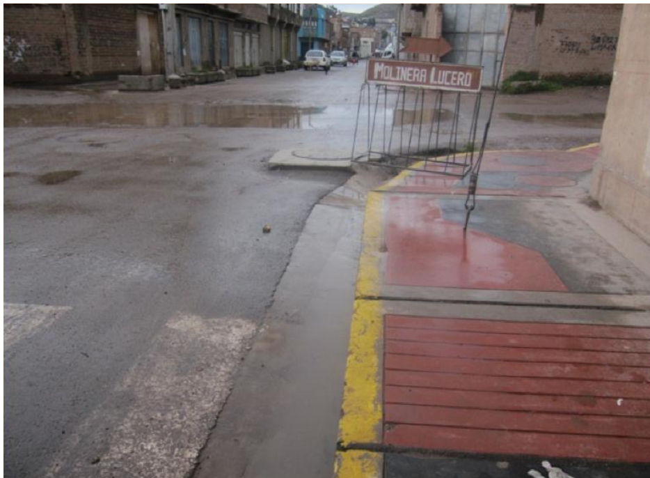
FOTOGRAFÍA N° 14: Se observa áreas de asentamiento del pavimento segmentado a manera de baches y que ocasiona estancamiento de agua. Jr. Nicolás Jarufe – Juliaca.
