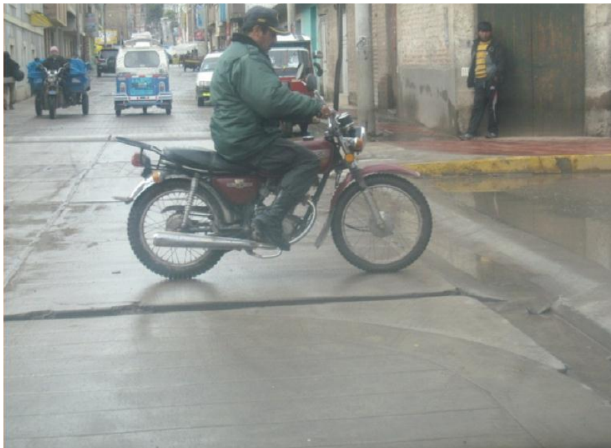
FOTOGRAFÍA N° 16: Se observa las cunetas laterales de la vía de mínimas dimensiones y sin funcionamiento. Jr. Nicolás Jarufe – Juliaca.
