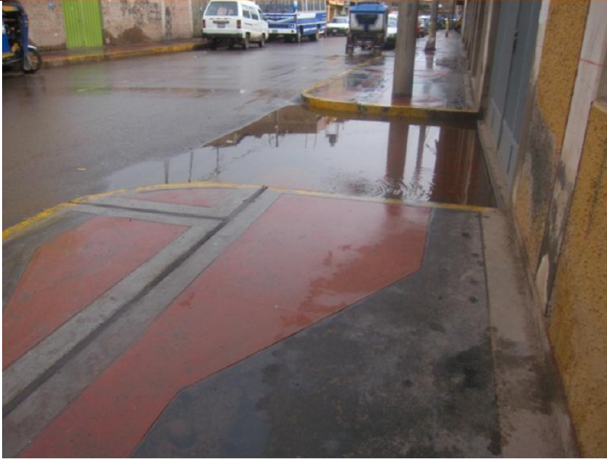
FOTOGRAFÍA N° 11: Se observa la falta de bombeo para el drenaje de aguas pluviales. Jr. Nicolás Jarufe – Juliaca.
