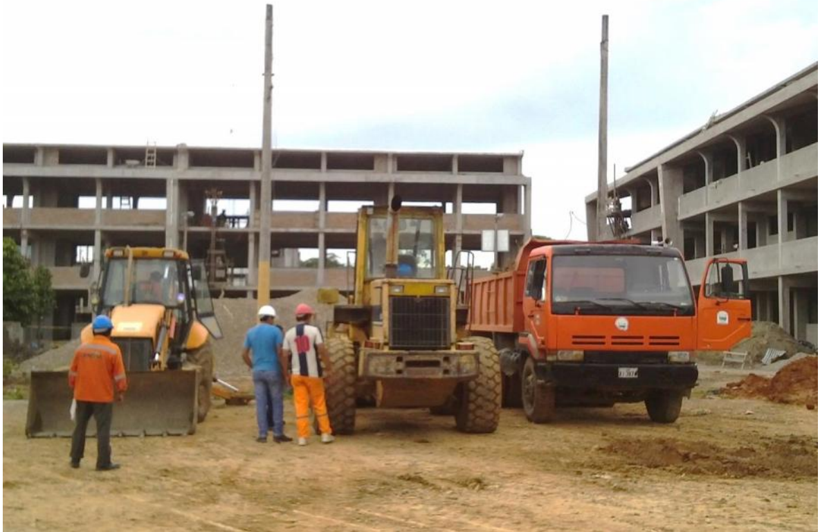
Figura 05. Equipo mecánico, sin extintores portátiles (tipo PQS – ABC).
