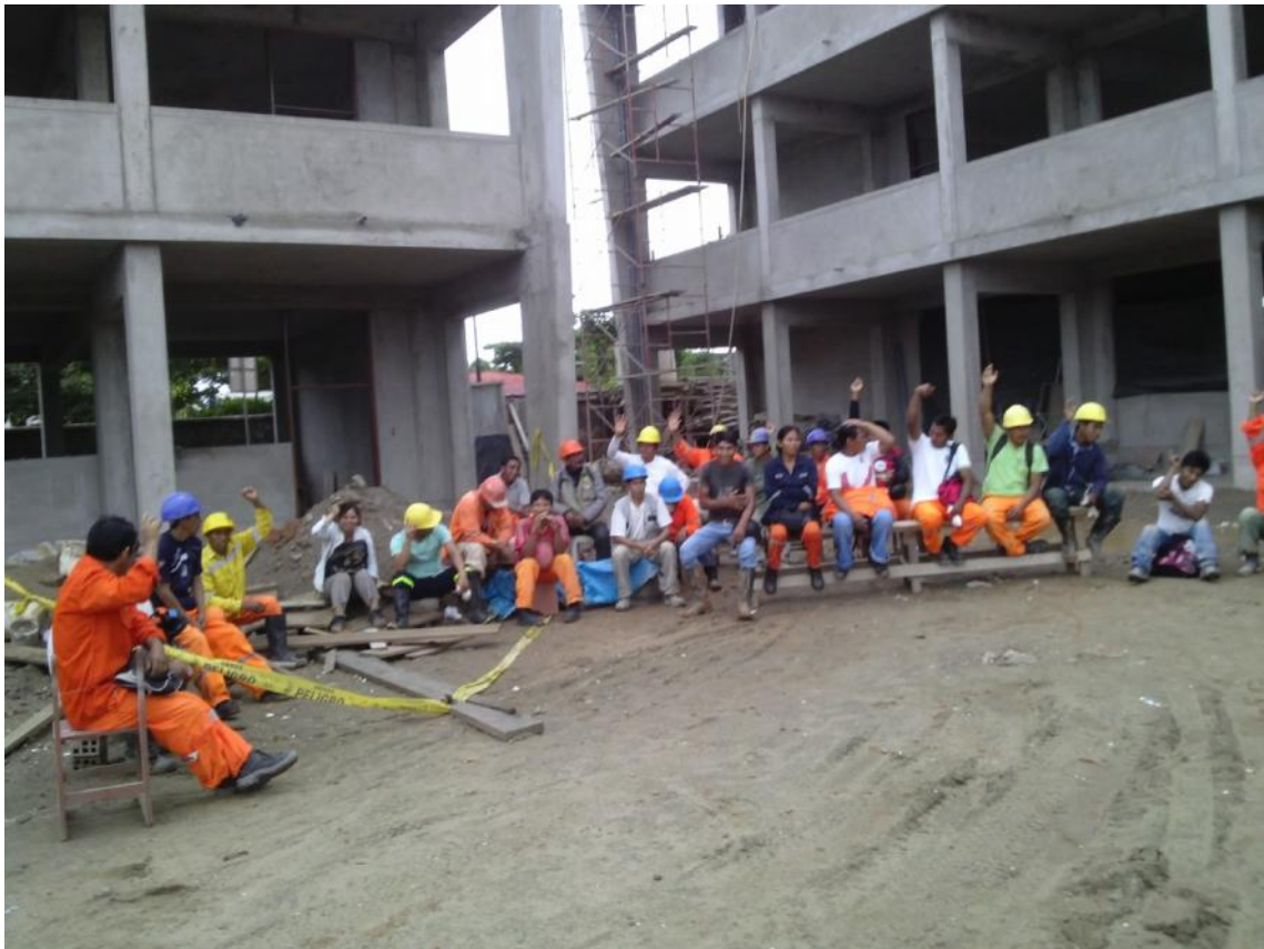
Figura 08. Reunión matutina de inducción en seguridad y salud ocupacional con los trabajadores, antes de empezar su jornada laboral.
