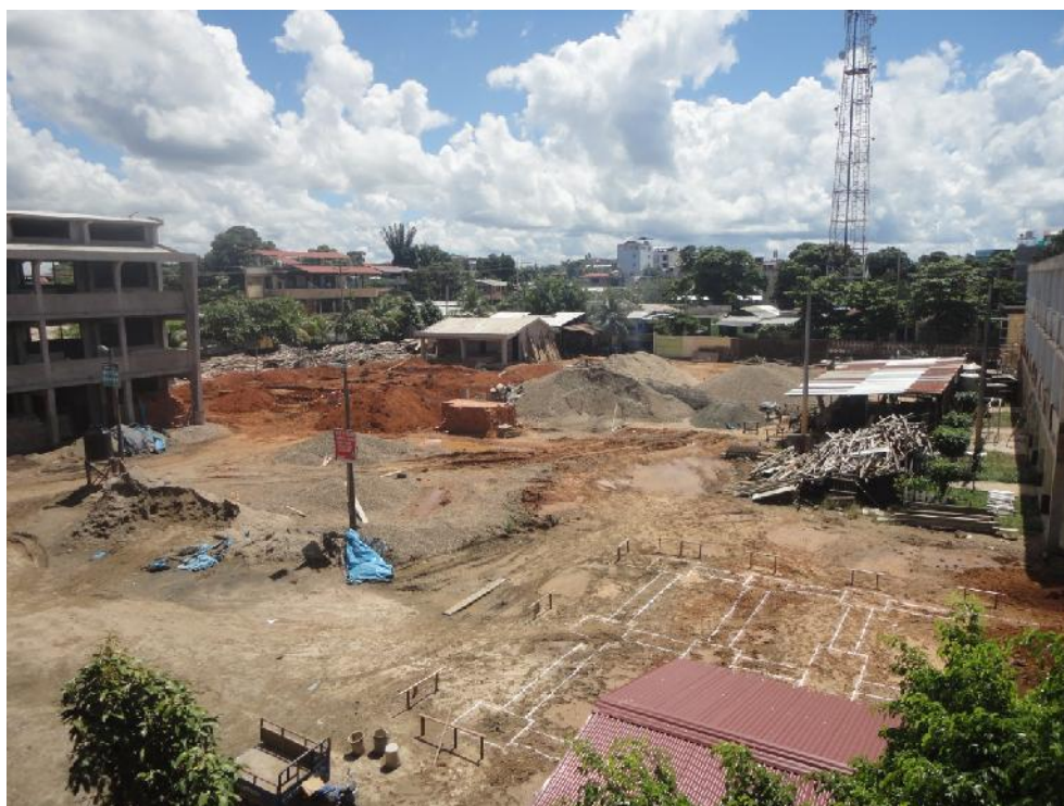
Figura 02. Vista interior de la obra, para elaborar el mapa de riesgos y la identificación de peligros y evaluación de riesgos, y su control (IPERC).
