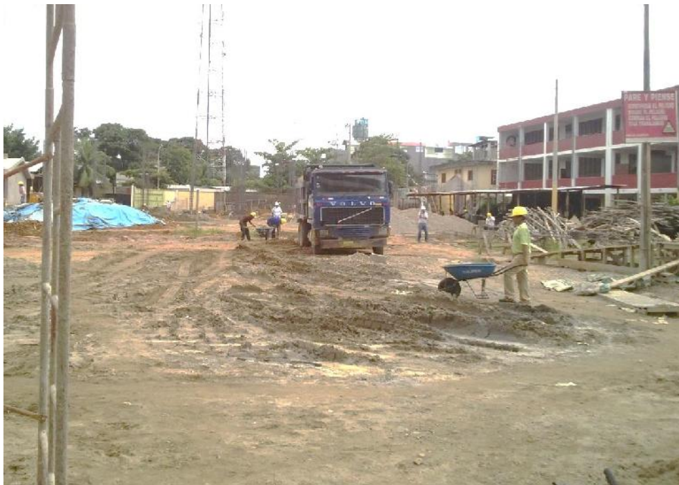
Figura 04. Se observa que varios trabajadores aún no cuentan con zapatos de seguridad, guantes, lentes y otros. Se deberá aplicar el programa de EPPs.
