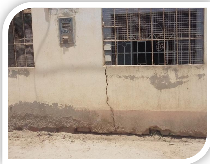
Imagen N°67 Muro totalmente agrietado en sentido diagonal, en Calle San José Cuadra 1 Del Centro Poblado 19 De Agosto, Distrito La Unión –Piura
