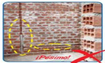
Imagen n°19 No picar muro portante debido que puede debilitarse
