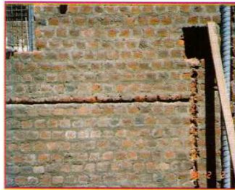
Imagen n° 51 muestra que no se debe picar los muros para alojar tubos
