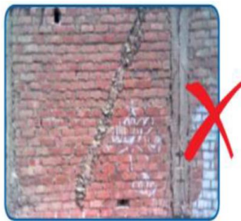
Imagen n° 20 Procedimiento constructivo incorrecto que afecta a la estructura y la debilita.
