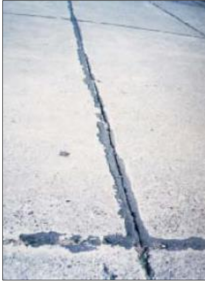
Imagen N° 15 Deficiencias de Sellado
