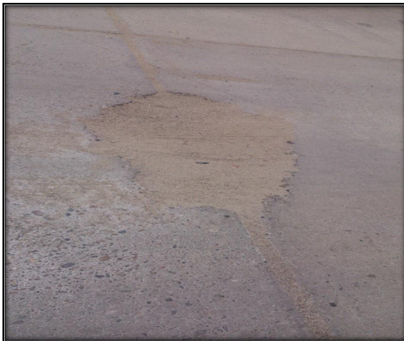
Imagen N° 56 Los descacaramientos y escamaduras, fallas en la superficie del concreto por deterioro o rotura.
