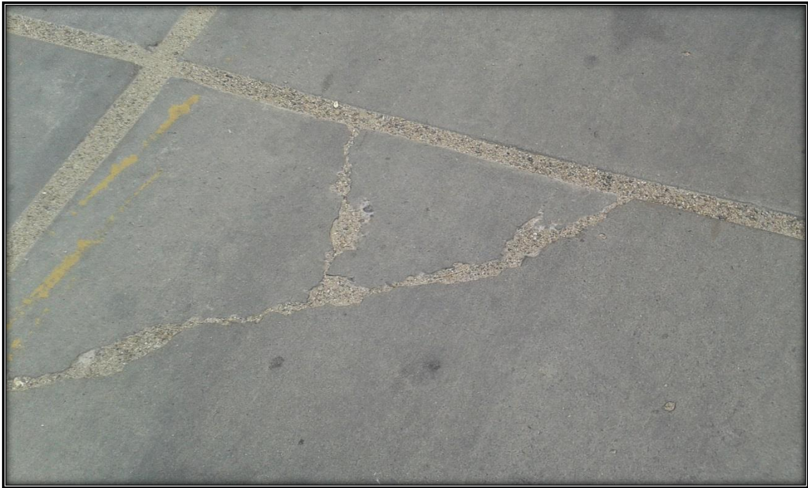
Imagen N° 42 Grietas de Esquina presentes también en los tramos en mención a lo largo del sector derecho estudiado.
