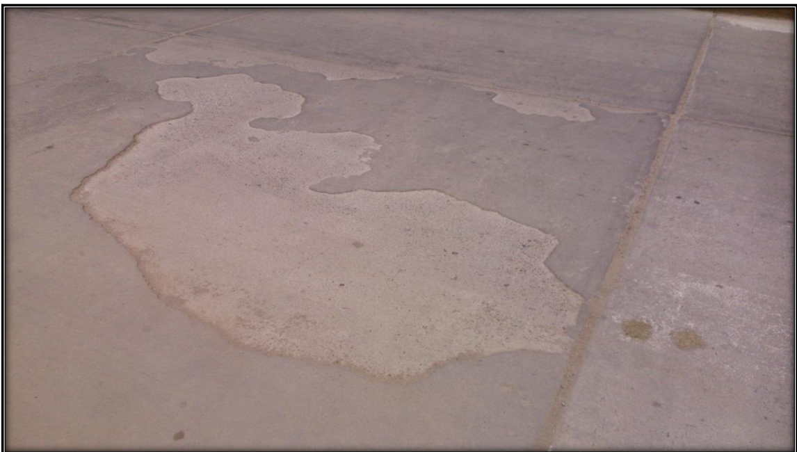
Imagen N° 52 Descascaramiento en el Pavimento ubicado en el sector de AA-HH Vate Manrique Mz C.
