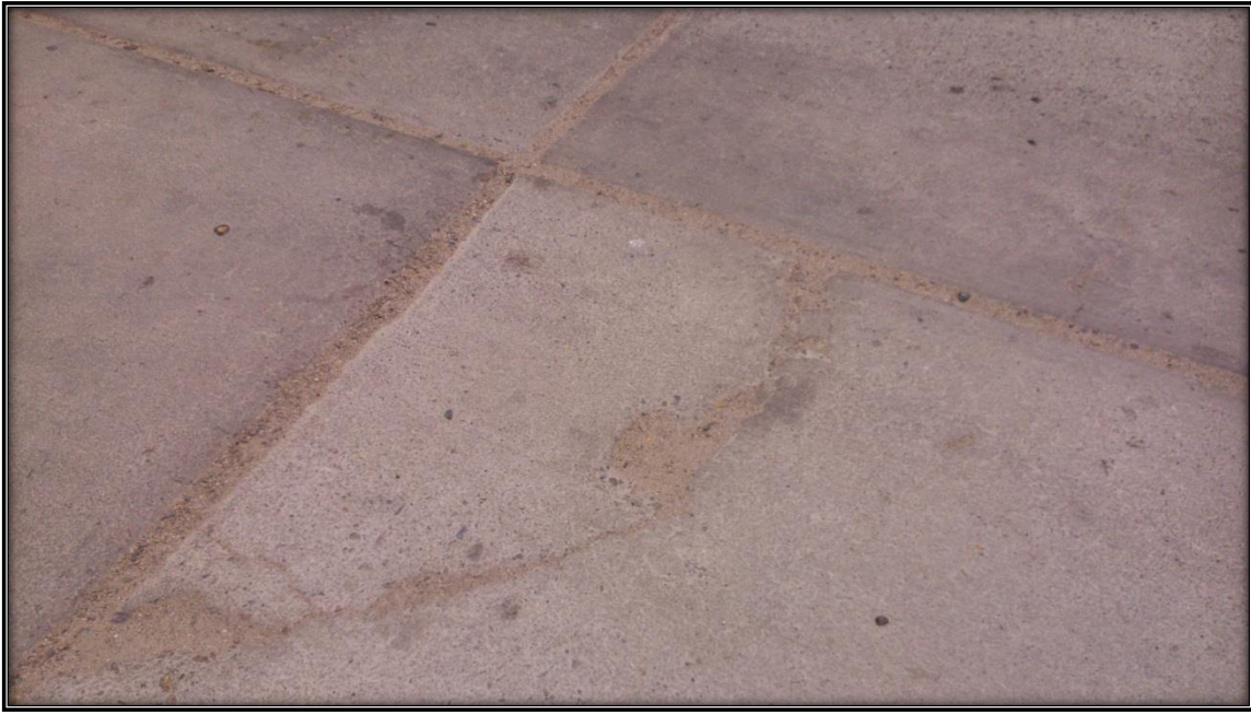
Imagen N° 55 Grietas de Esquina presentes también en los tramos en mención a lo largo del sector izquierdo estudiado.
