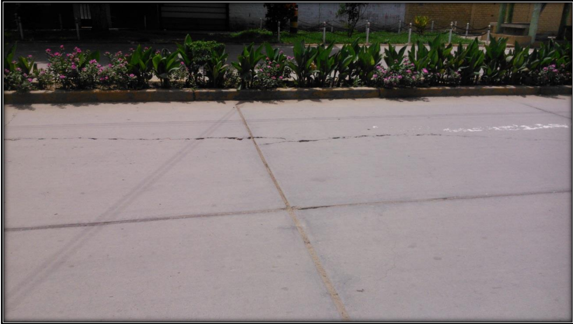
Imagen N° 53 Grietas Longitudinales debido a la falta de mantenimiento ubicado en el sector de AA-HH Vate Manrique Mz A.
