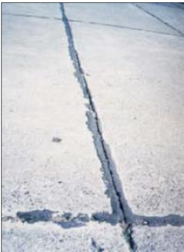
Imagen N° 09 Deficiencias de Sellado
