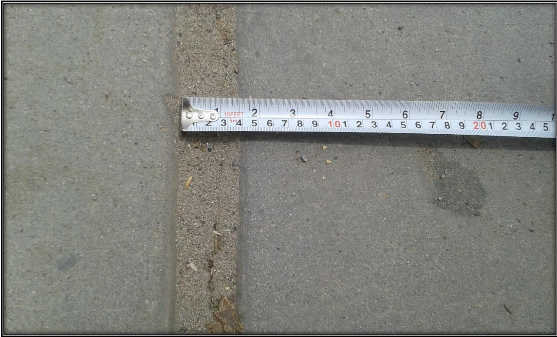
Imagen N° 46 Sello de Junta totalmente deteriorado y cubierto por material de residuos diarios y presenta un espaciamiento de junta de 4 cm lo que no está especificado por normatividad y que con el paso de los años se ha espaciado más.
