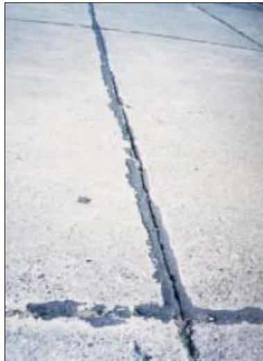
Imagen N° 09 Deficiencias de Sellado
