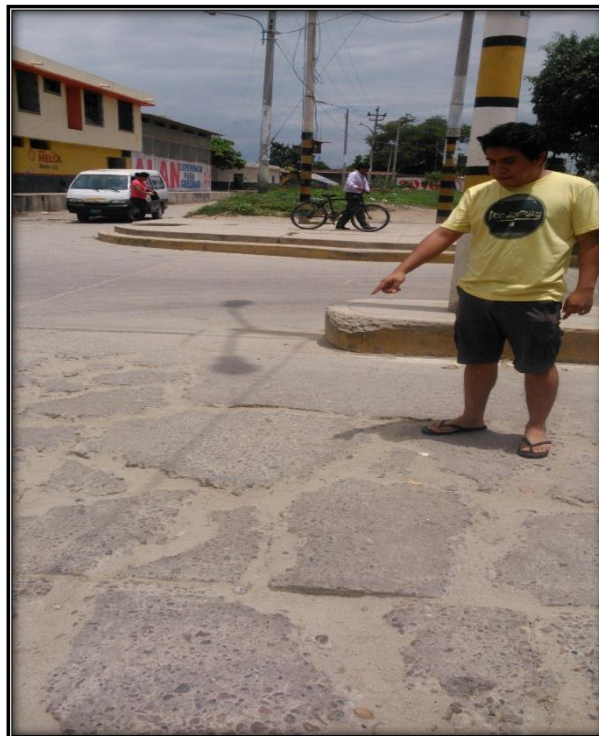
Imagen N° 50 Rotura en el Pavimento ubicado en el sector de AA-HH Vate Manrique Mz E.
