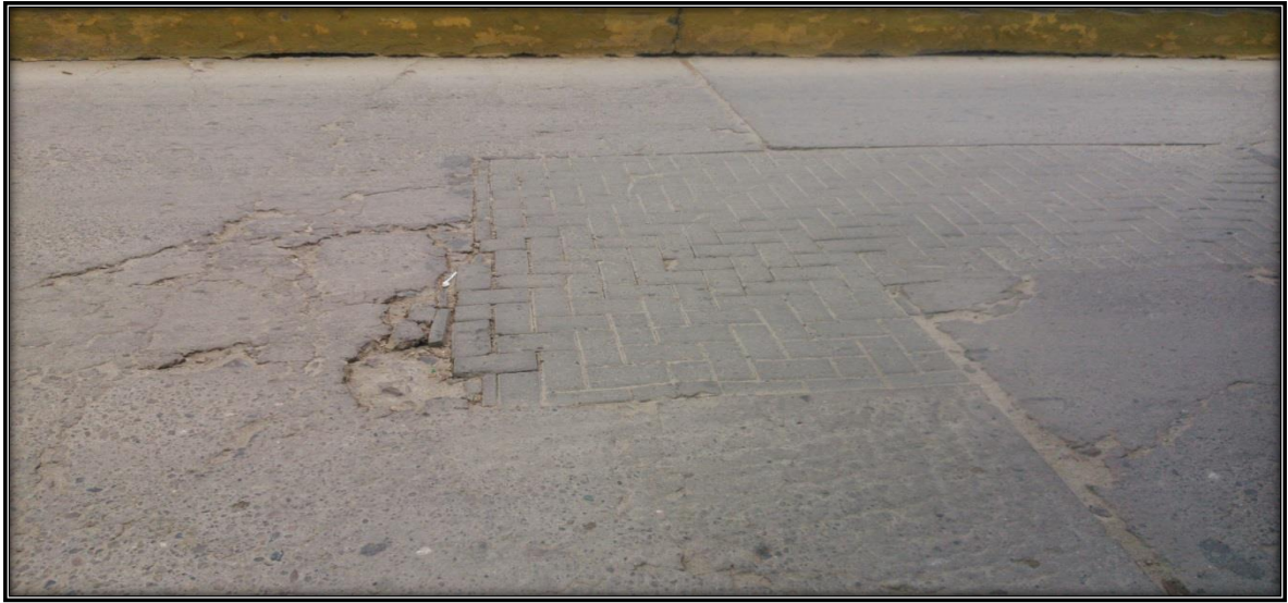
Imagen N° 49 Parche en mal estado y atravesando la junta de Dilatación.
