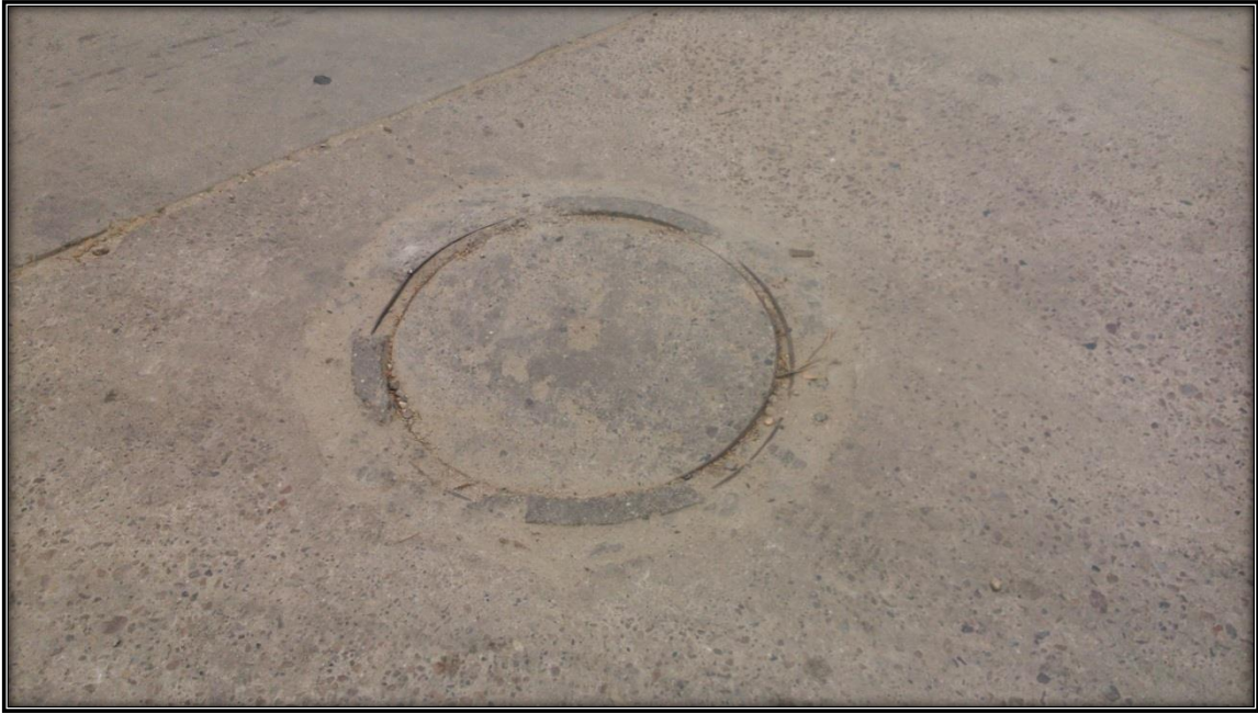
Imagen N° 51 Buzón con juntas de dilatación en mal estado debido a la falta de mantenimiento ubicado en el sector de AA-HH Vate Manrique Mz D.
