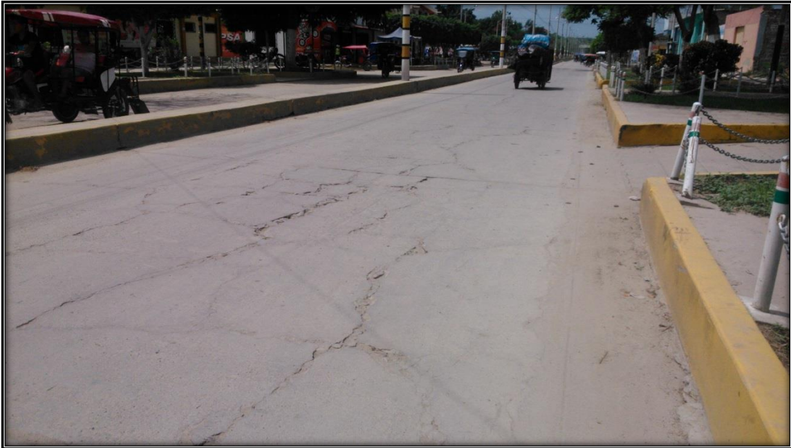
Imagen N° 48 Grietas Longitudinales en pronunciado espaciamiento en el sector de la Comisaria de Chulucanas.
