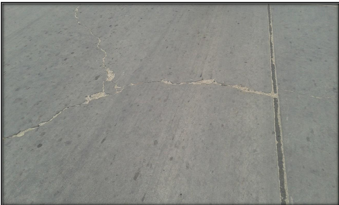
Imagen N° 41 Grietas Transversales y Deficiencias de sellado ya deteriorado por el paso de los años.
