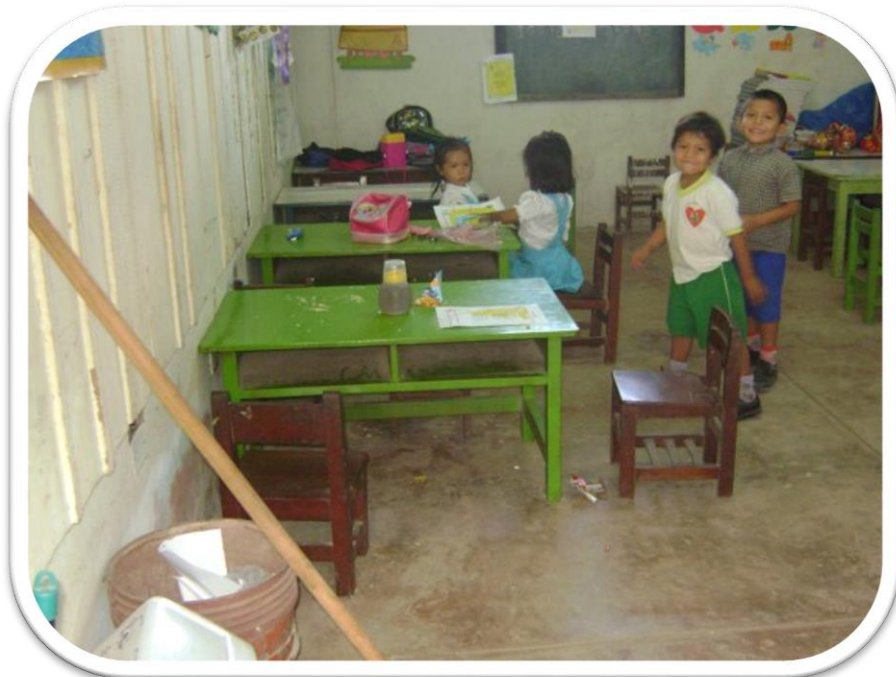
Vista interior del aula, se observa piso de cemento y paredes de madera en mal estado
