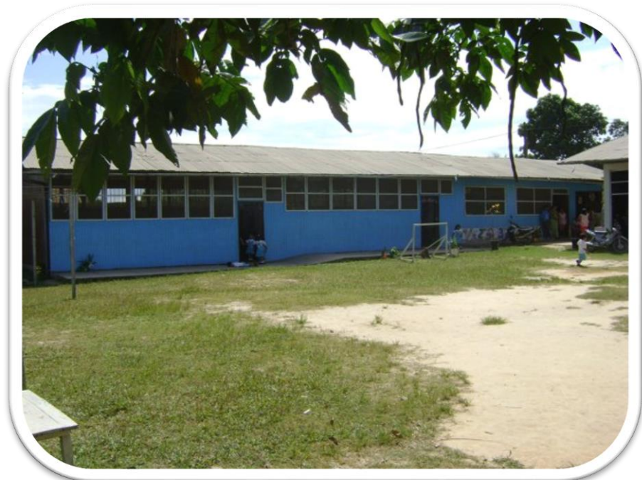
Vista de pabellón N°1 de material de madera en mal estado
