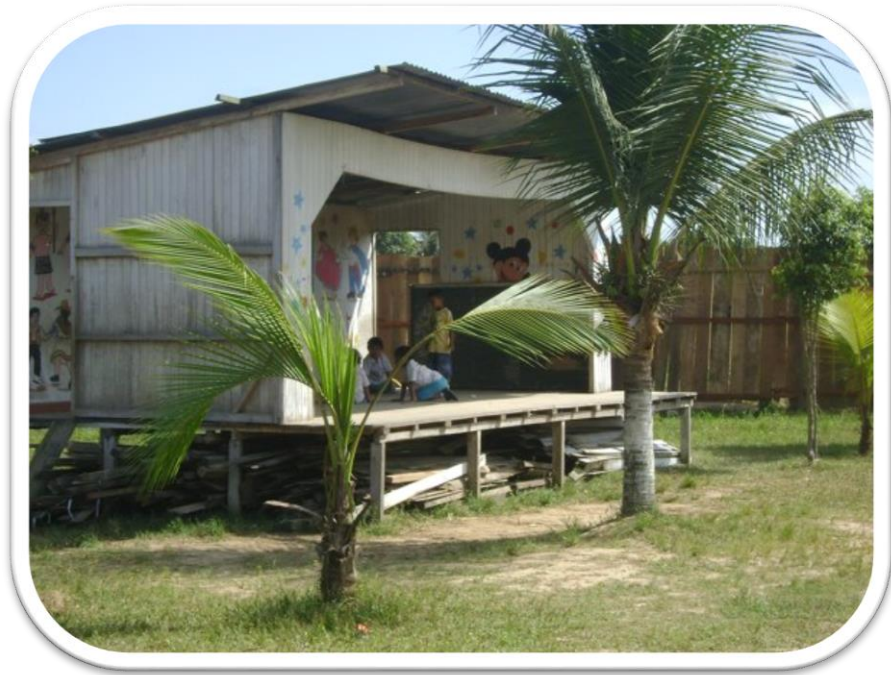
Vista del escenario de madera en mal estado
