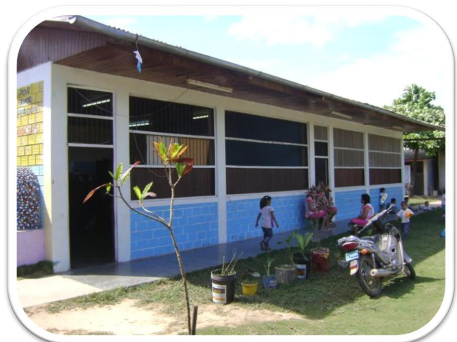
Vista del Pabellón N°2 de material seminoble, estructuralmente en mal estado
