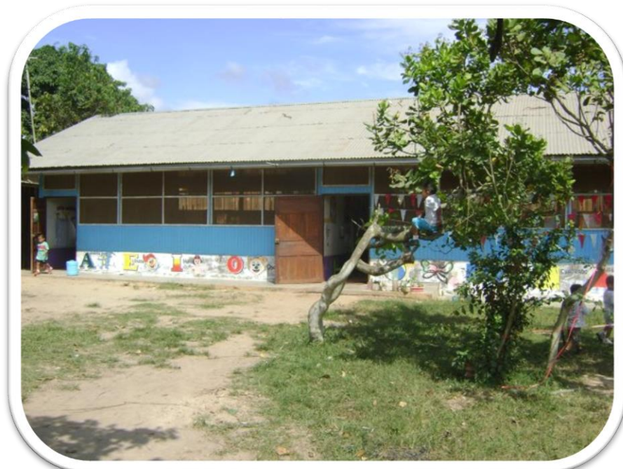
Vista del Pabellón N°3 de Madera con zócalo de ladrillo, estructuralmente en mal estado
