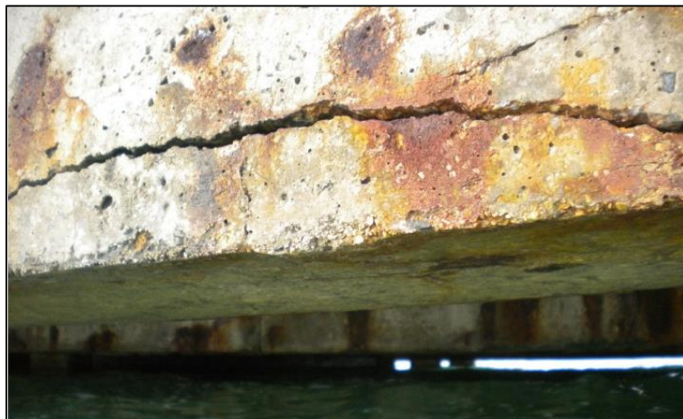
Imagen N° 02: Viga en pórtico (embarcadero) fisura producida por la expansión de la armadura en su proceso corrosivo
