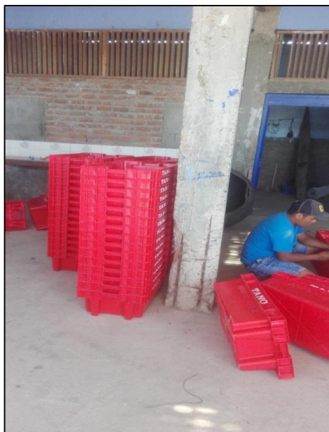
Imagen N° 25: Desprendimiento del recubrimiento concreto -las Delicias “V-7”
