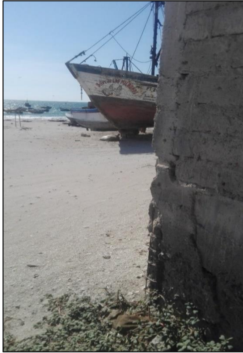
Imagen N° 27: Daño en columna por desprendimiento del concreto Las Delicias "V-9"
