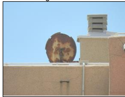
Imagen N° 06: Oxidación en Antena parabólica
