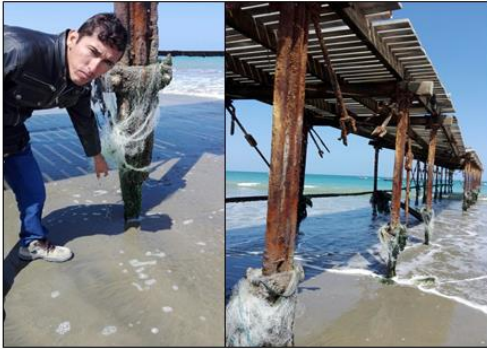
Imagen N° 07: Estructura de metal y madera; deteriorada por contacto con el agua de mar.
