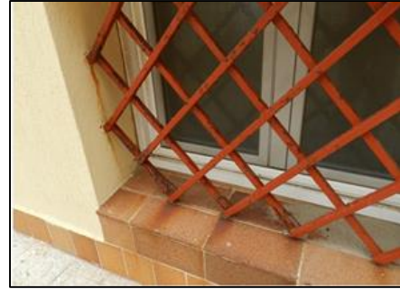
Imagen N° 05: Oxidación en Rejas
