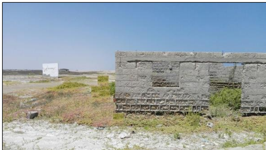
Imagen N° 20: El desgaste de muros es severo cabe mencionar que el terreno no es apto para construcción- Chulliyache “V-2”
