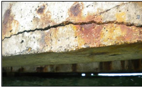
Imagen N° 01: Pórtico de embarcadero totalmente fisurado
