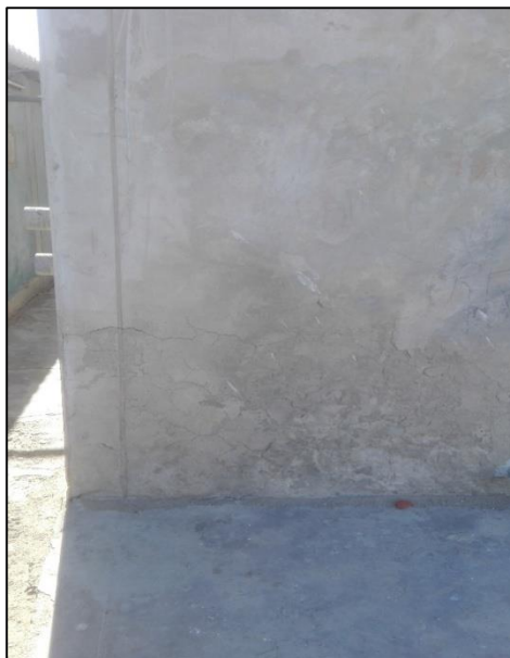
Imagen N° 26: Micro fisuras en columna, eflorescencia en muros - Las Delicias “V-8”
