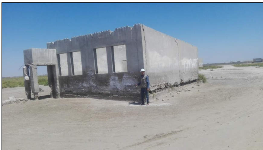
Imagen N° 19: Terreno totalmente salitroso deterioro de la estructura – Chulliyache “V-1” Fuente: propia
