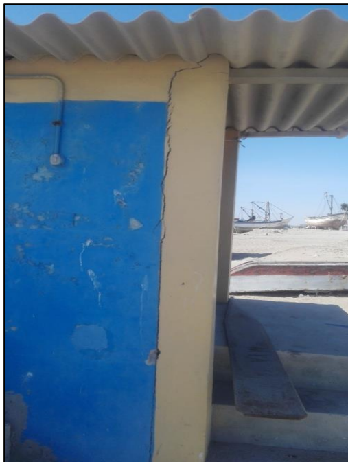
Imagen N° 24: grieta entre columna y muro – Las Delicias "V-6"
