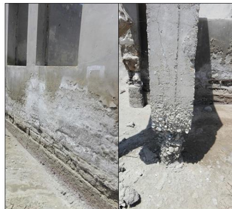
Imagen N° 09: Playa Chulliyaque; Muros deteriorados por los sulfatos y columna desgastados por las sales
