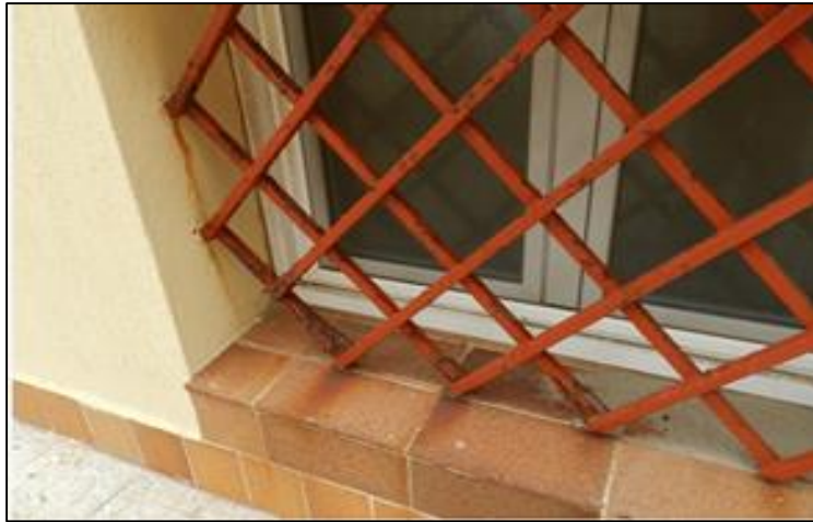
Imagen N° 05: Oxidación en Rejas Fuente: Código técnico de la edificación
