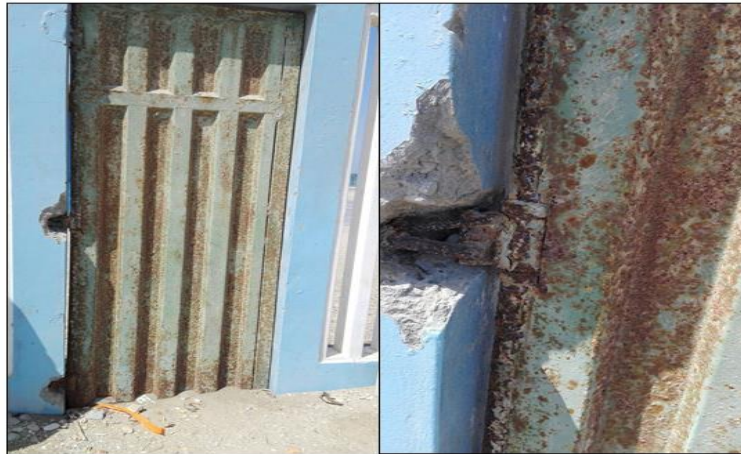
Imagen N° 4: Elementos metálicos oxidados debido al ambiente marino
