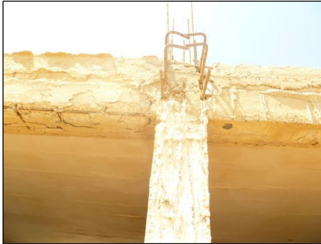
Imagen 14. Desprendimiento del concreto causando vulnerabilidad en la armadura
