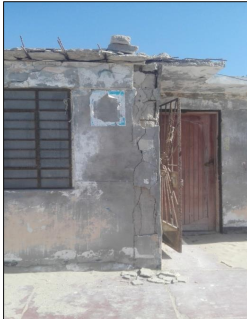
Imagen N° 23: grieta entre muro y columna - Mata Caballo "V-5"
