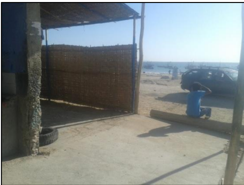
Imagen N° 10: Columna en mal estado a causa de los sulfatos, quedando el acero expuesto al ambiente.
