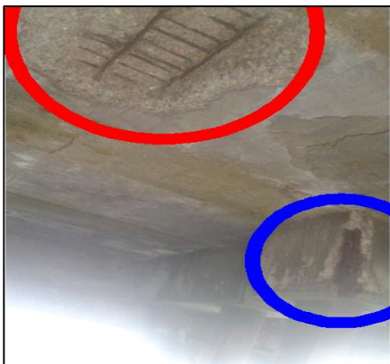
Imagen N° 11: Losa de concreto armado desprendido a causa de los sulfatos y el acero se encuentra a intemperie.
