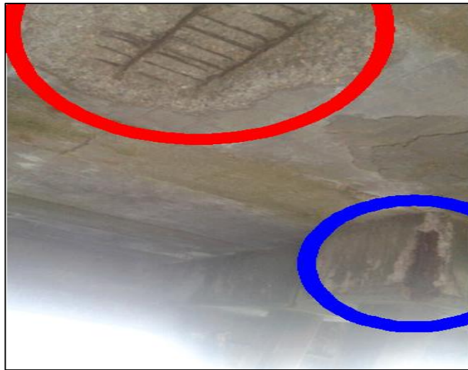
Imagen N° 11: Losa de concreto armado acero expuesto al ambiente, desprendido a causa del aumento del volumen del acero
