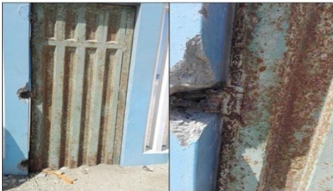
Imagen N° 04: Elementos metálicos oxidados debido al ambiente marino
