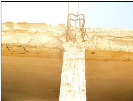
Imagen N° 14. Desprendimiento del concreto causando vulnerabilidad en la armadura
