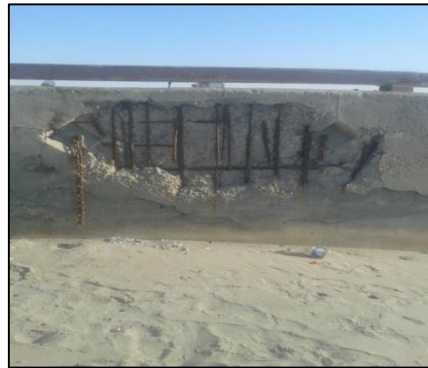
Imagen N° 12: Desprendimiento del concreto por causa de la abrasión y/o por los sulfatos del agua de mar.
