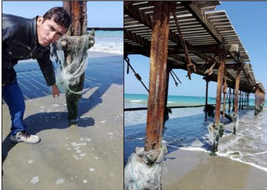
Imagen N° 7: Estructura de metal, desgastada por contacto con el agua de mar.
