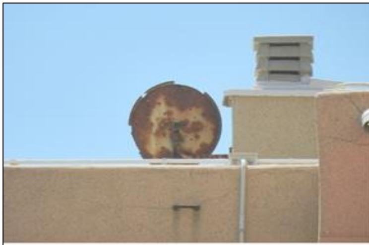
Imagen N° 06: Oxidación en Antena parabólica Fuente: Código técnico de la edificación
