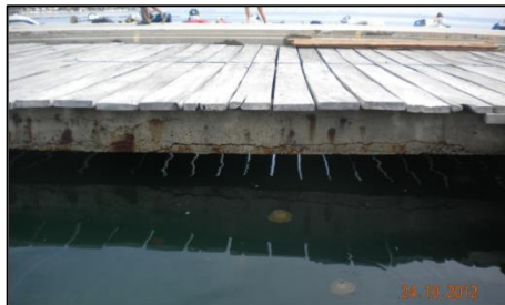
Imagen N° 02: Viga en pórtico (embarcadero) fisura producida por la expansión de la armadura en su proceso corrosivo
