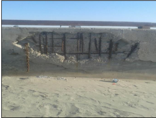
Imagen N° 12: Desintegración del acero
