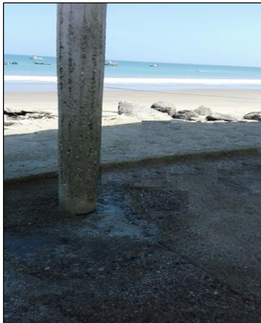
Imagen N° 22: Manchas de óxido en toda la columna - Mata Caballo“V-4”
