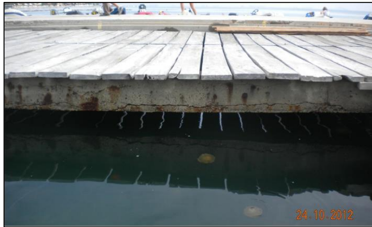
Imagen N° 01: Pórtico de embarcadero totalmente fisurado
