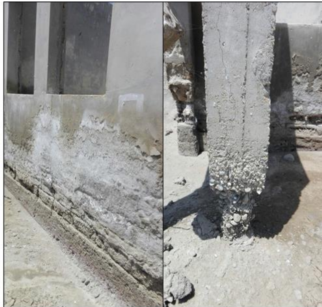
Imagen N° 09: Muros deteriorados por los sulfatos y columna desgastados por las sales - Playa Chulliyaque
