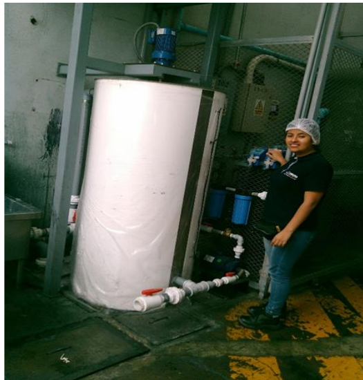
Vista de los dosificadores del Sistema de Tratamiento de Aguas Residuales Industriales
