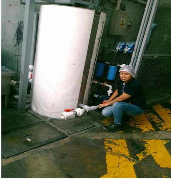
Vista de la llave de paso para la recirculación de las aguas tratadas
