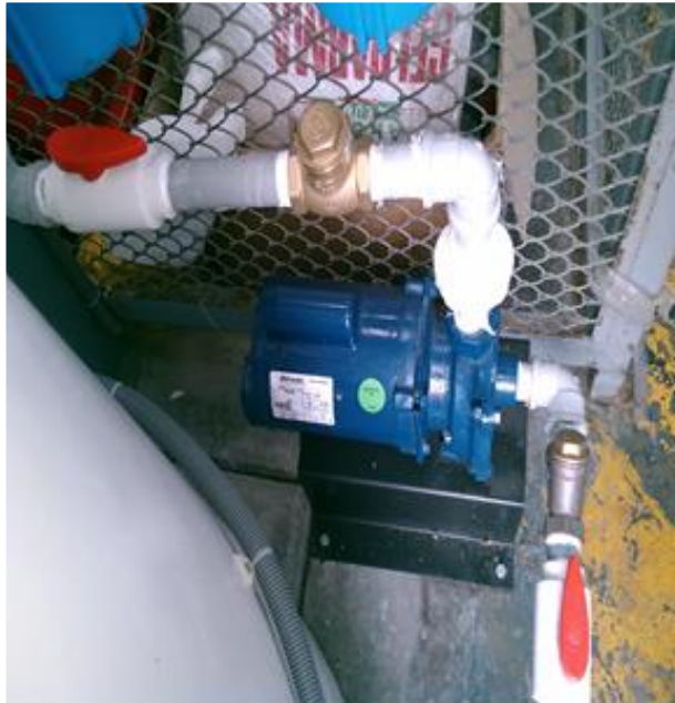
Vista de la bomba de impulsión
