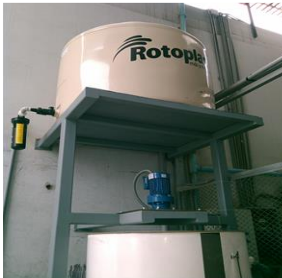
Vista del tanque de Rotoplast que capta el agua tratada
