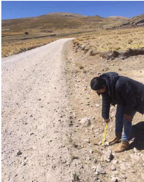
FOTO 7. Cuneta en mal estado Progresiva 07+500
