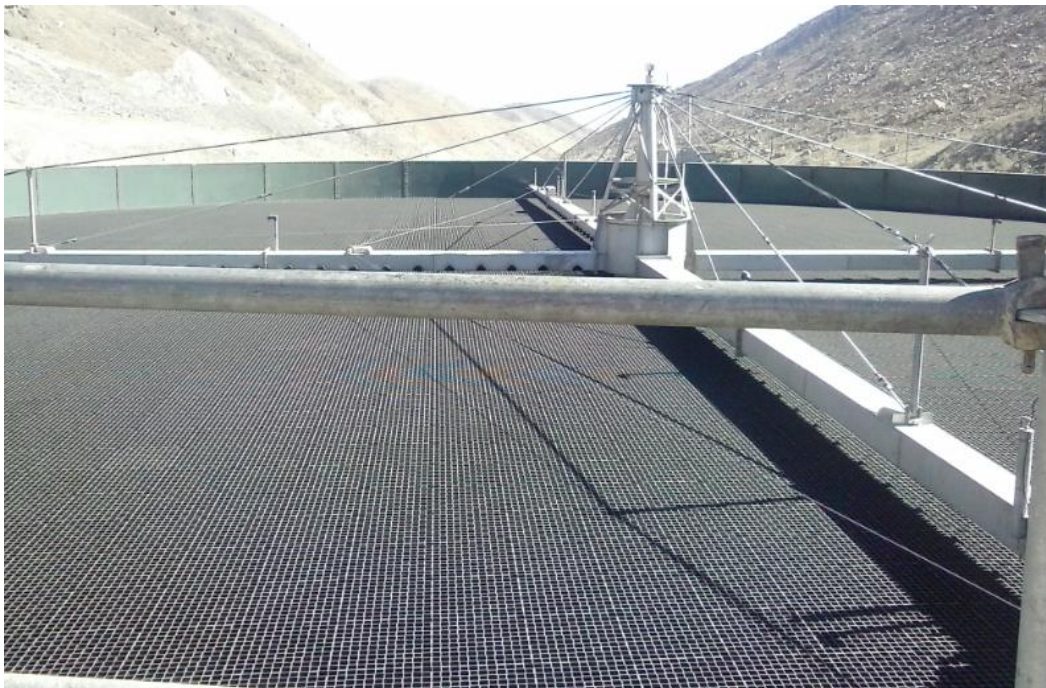
Figura N°20: aspersor de tanque.
