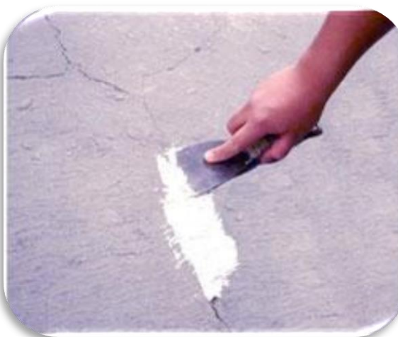
Figura 2. 21 GRIETAS CAPILARES O CUARTEADURAS EN UNA LOSA DE CONCRETO
