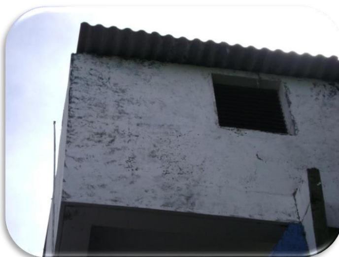
Figura 2. 13 CONCRETO MANCHADO EN SUPERFICIAL
