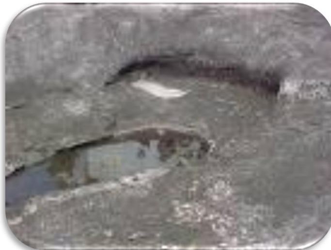
Figura 2. 12 CONCRETO METEORIZACIÓN EN SU CAPA SUPERFICIAL
