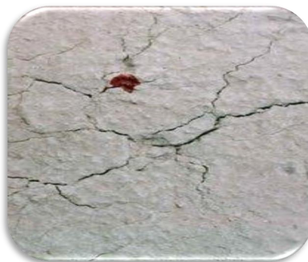
Figura 2. 20 FISURAS EN UNA LOSA DE CONCRETO, POR VIBRACIÓN DE LA BASE, DURANTE EL FRAGUADO DEL CONCRETO.
