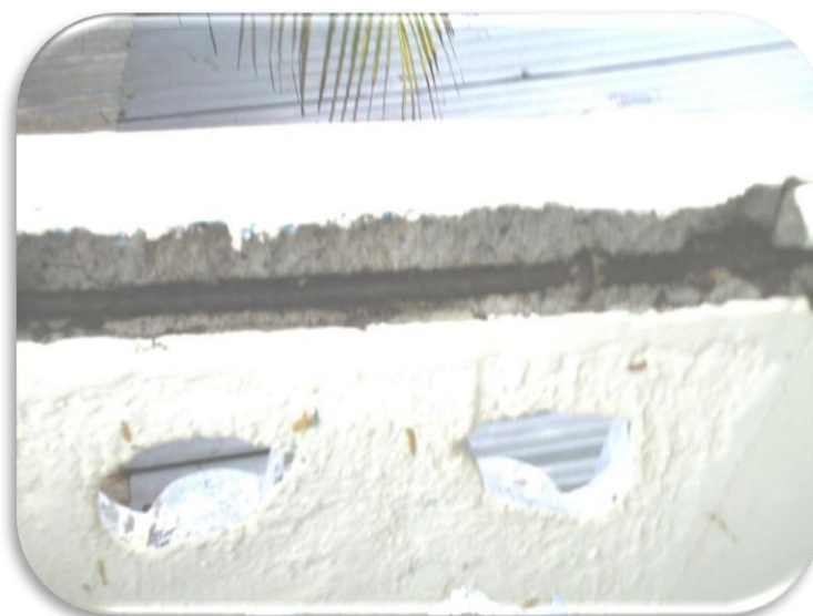
Figura 2. 5 SINTOMAS SUPERFICIALES DE DAÑOS EN ESTRUCTURA DE CONCRETO
