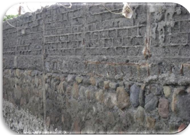
Figura 2.15 ASPECTO DE UN CONCRETO DETERIORADO POR EXPANSIÓN
