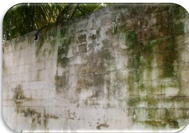
Figura 2. 9 FACHÁDA AFECTADA EN SU APARIENCIA POR ESCURRIMIENTO DIFERENCIAL DEL AGUA LLUVIA SOBRE SU SUPERFICIE.
