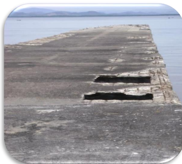
Figura 2. 14 ASPECTO DE UN CONCRETO DETERIORADO POR EXPANSIÓN DEBIDO A ATAQUES DE SULFATOS.
