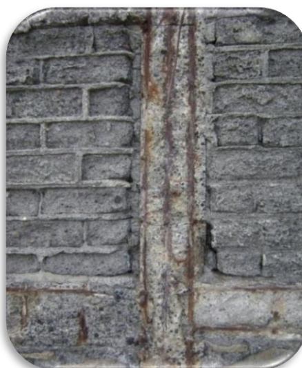
Figura 2.16 CORROSIÓN DEL ACERO DE REFUERZO POR DESPASIVACIÓN DEL RECUBRIMIENTO.
