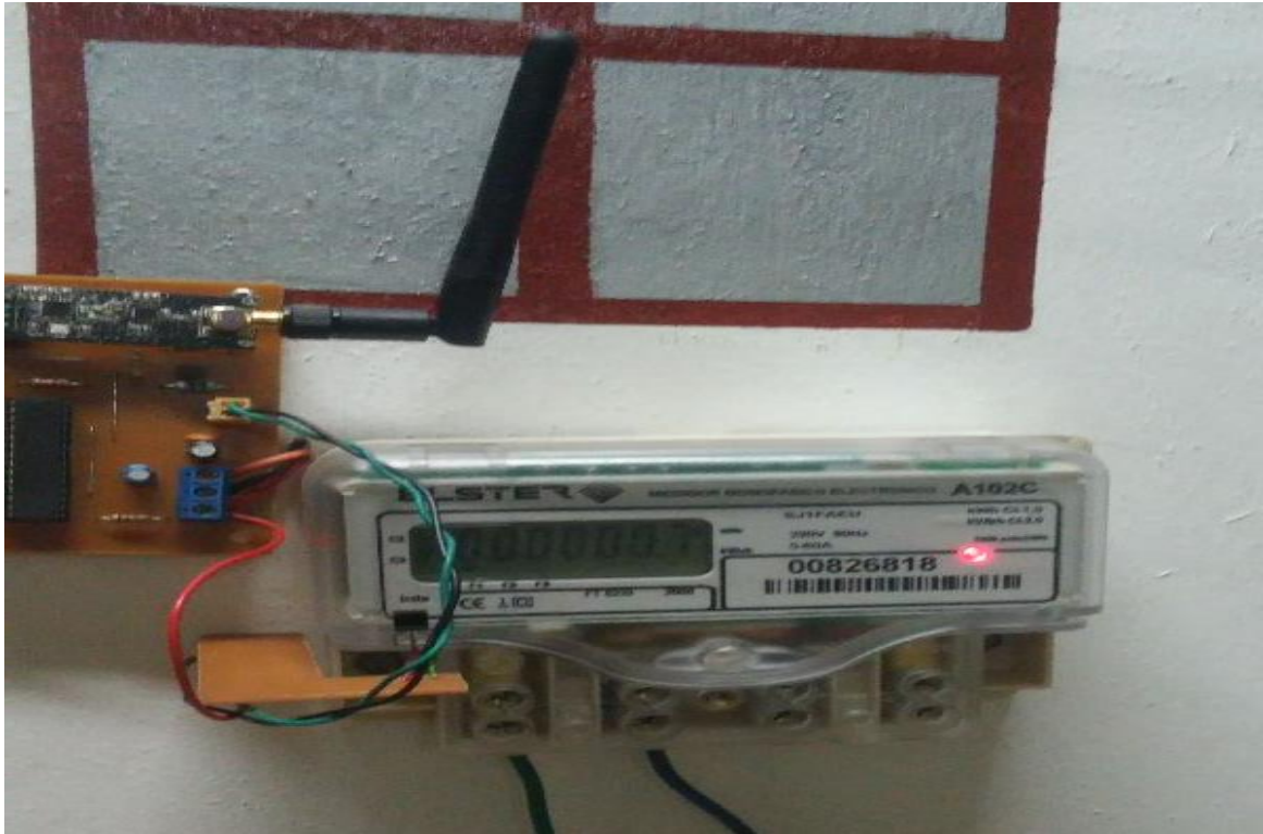
Foto 7 Pruebas con el medidor de energía eléctrica
