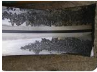
Figura 1, zonas con remoción de material debido al desgaste abrasivo con un avanzado descascarillado en las pistas de rodadura
