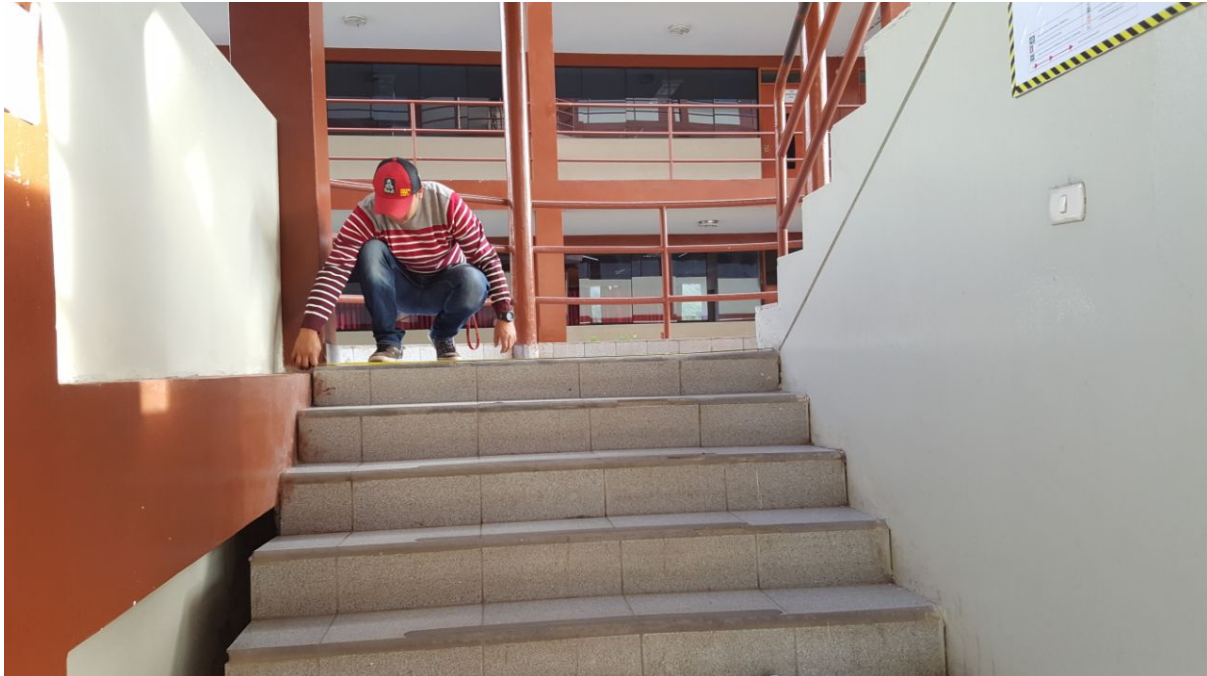
Figura 10: Medición de las dimensiones de la escalera del pabellón A de la UAP Sub sede Abancay
