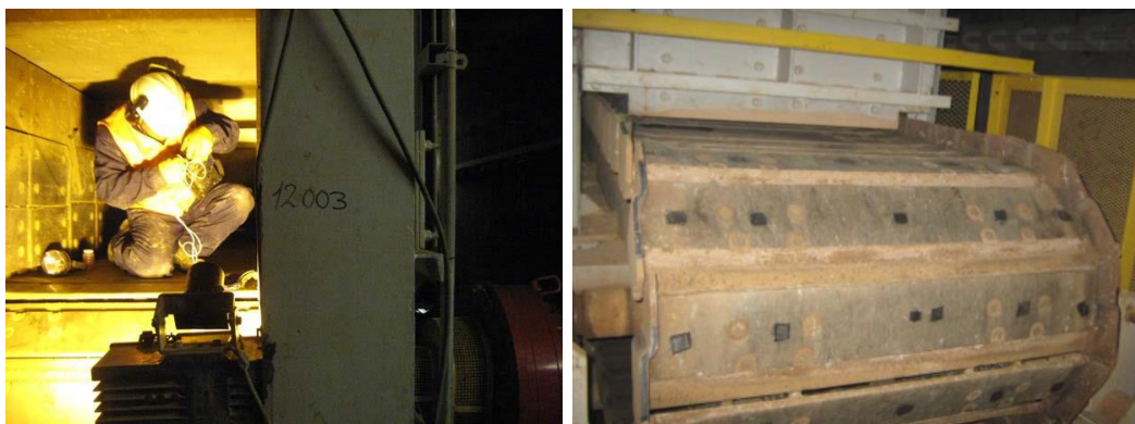
Figura: 56 Inspección de chute y Artesas Fuente: Elaboración Propia – Ingeniería Mantenimiento MYSRL
