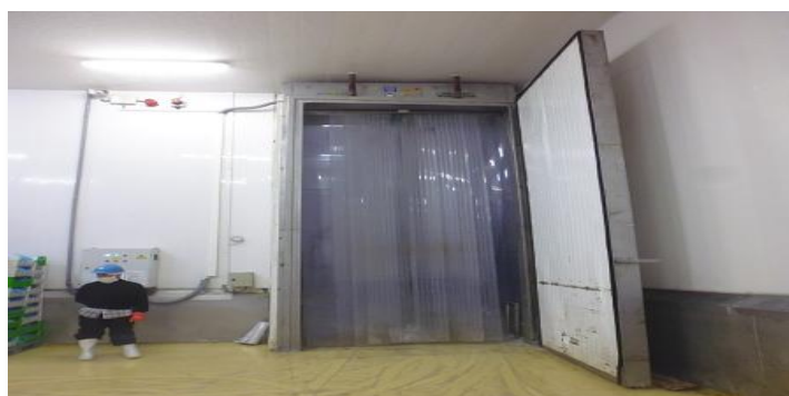
Figura N° 32: Cámara de Principal de almacenamiento.
