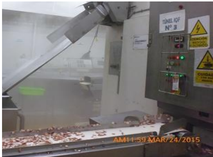
Figura N° 28: TÚNEL DE CONGELAMIENTO IQF
