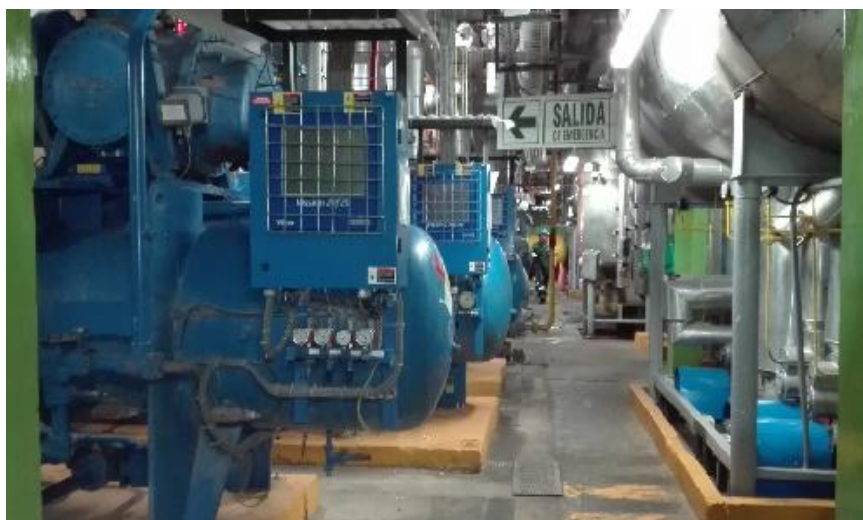
FIGURA N° 42: SALA DE COMPRESORES DE AMONÍACO.
