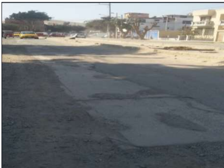
Tipo de falla – Pulimiento en la Av. Fernando León Arechua
